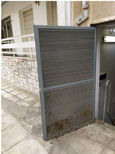
Εικόνα 82 Εξωτερική πόρτα Υ/Σ με αεροθυρίδες για να έχουμε τον απαιτούμενο εξαερισμό στον Υ/Σ
