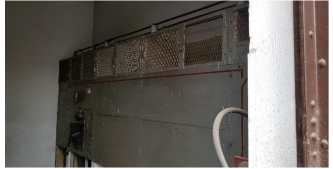
Εικόνα 65 Οι πρώτοι Πίνακες Μέσης Τάσης
