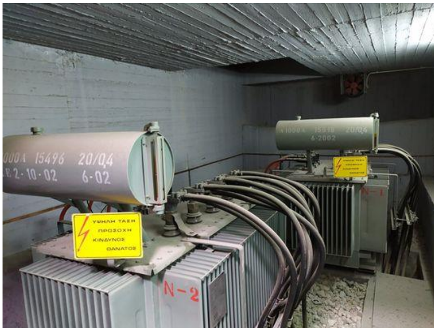
Εικόνα 98 Σημάνσεις αναγγελίας κινδύνου & Υψηλής Τάσης στον χώρο των Μ/Σ
