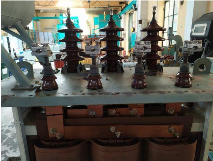
Εικόνα 33 Ακροδέκτες Χαμηλής Τάσης
