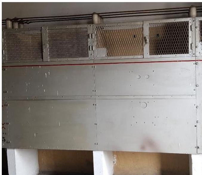
Εικόνα 67 Πίνακας Μέσης Τάσης – Εφεδρικές καμπίνες
