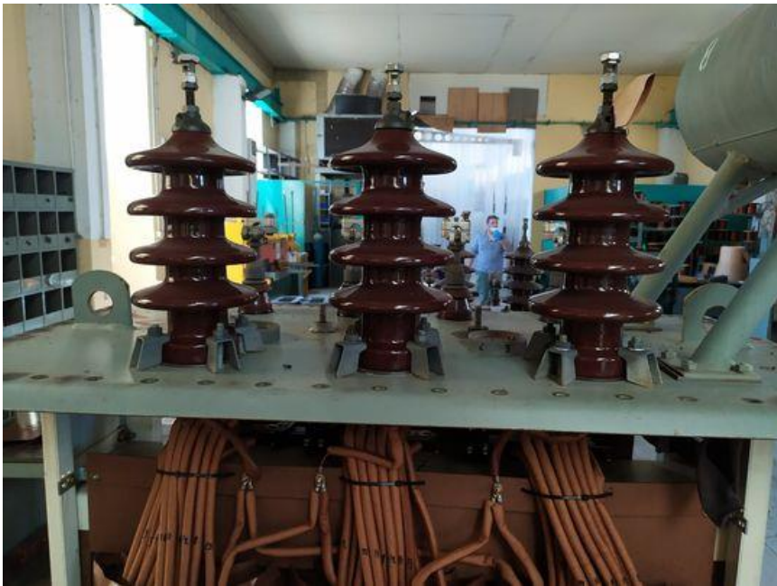
Εικόνα 32 Ακροδέκτες Υψηλής Τάσης
