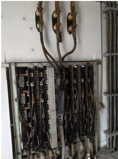
Εικόνα 70 Καλώδια Μέσης Τάσης τα οποία ανεβαίνοντας στον τοίχο μέσω των γενικών μαχαιριών καταλήγουν στον Πίνακα Χαμηλής Τάσης
