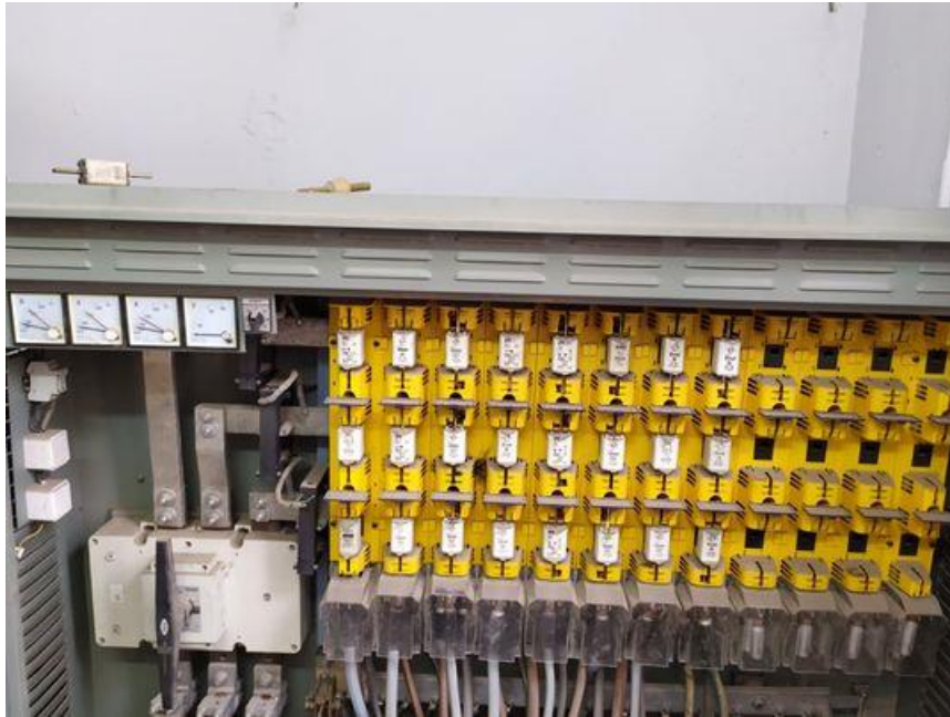
Εικόνα 88 Ο Νέου τύπου Πίνακας Χαμηλής Τάσης του Υ/Σ Πόλεως ΠΚ-19 με Διακόπτη Φορτίου, με πρόβλεψη 12 αναχωρήσεων
