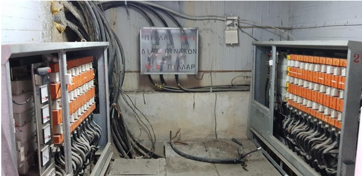
Εικόνα 101 Διασύνδεση Πινάκων Χαμηλής Τάσης
