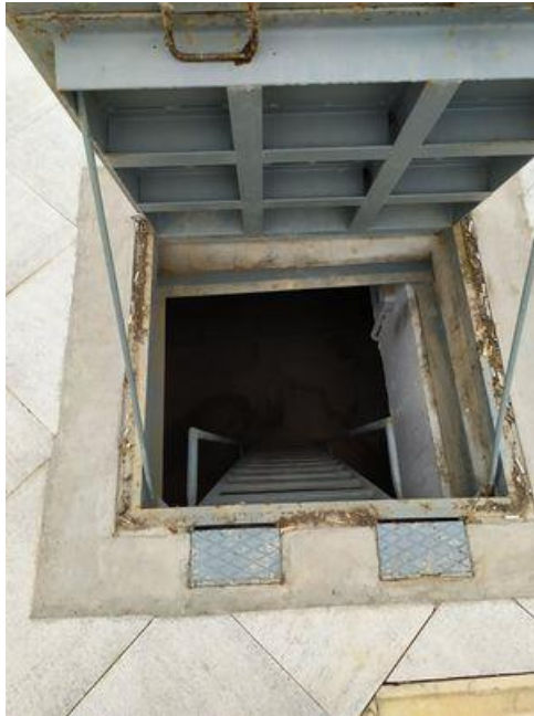
Εικόνα 95 Είσοδος του Υπόγειου Υ/Σ Πόλεως ΠΚ-73 στον Κορυδαλλό
