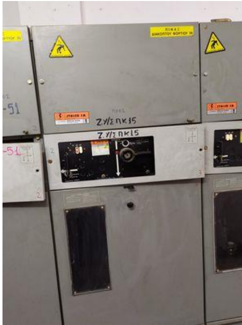
Εικόνα 86 Οι Επιμέρους μονάδες του Πίνακα Μέσης Τάσης του Υ/Σ Πόλεως ΠΚ-19
