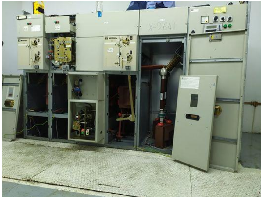
Εικόνα 113 Ανοιχτός Πίνακας ΔΕΔΔΗΕ
