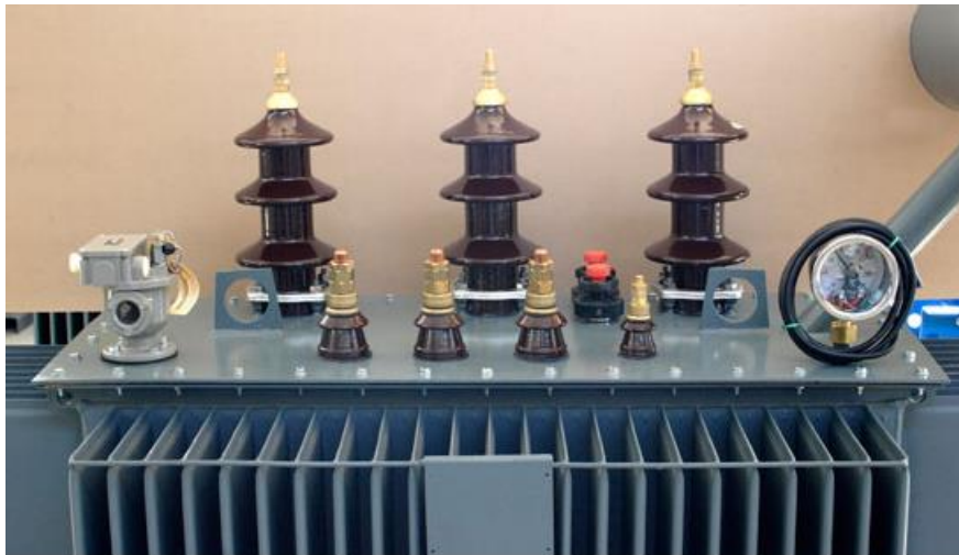
Εικόνα 28 Ακροδέκτες Χαμηλής Τάσης και Μέσης Τάσης
