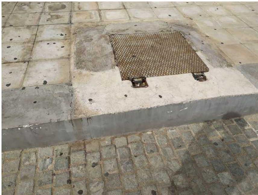
Εικόνα 94 Είσοδος του Υπόγειου Υ/Σ Πόλεως ΠΚ-73 στον Κορυδαλλό
