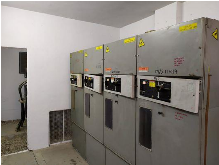
Εικόνα 84 Νεότερος Πίνακας Μέσης Τάσης με τέσσερις επιμέρους καμπίνες
