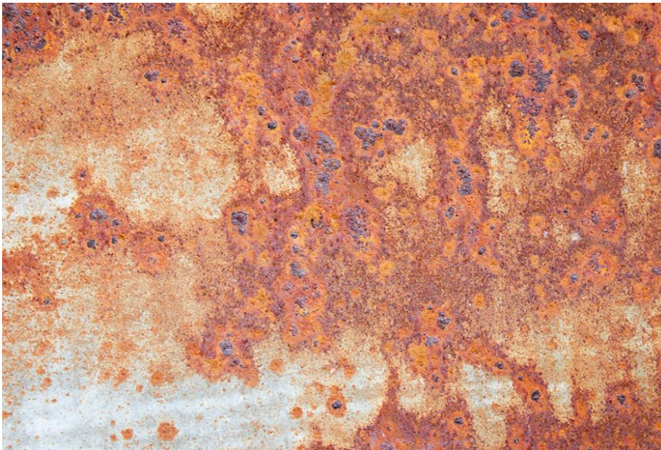
Εικόνα 14: Παράδειγμα γενικής διάβρωσης σε επιφάνεια χάλυβα [πηγή Steel Fabrication Services].
