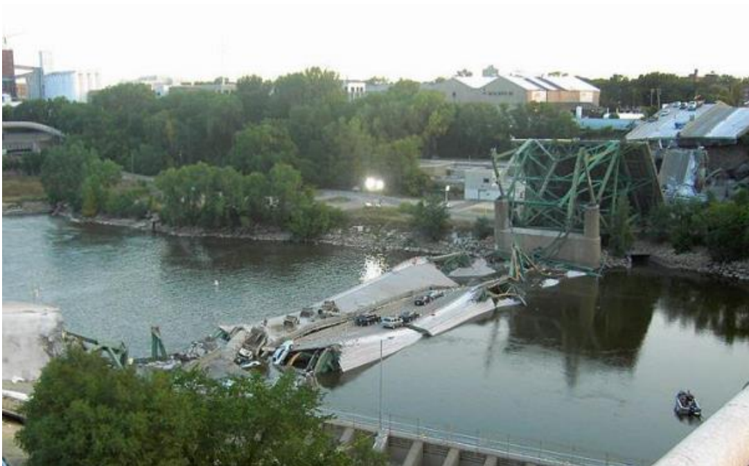
Εικόνα 11: Άλλο ένα παράδειγμα κατάρρευσης γέφυρας αυτήν την φορά κοντά σε υδατικό περιβάλλον, στην οποία παρατηρούνται σπασμένα μεταλλικά στηρίγματα .
