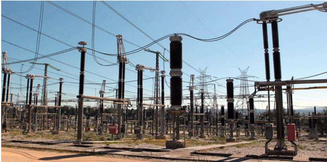
Figure 2.12: Κέντρο υπερυψηλής τάσης Παλλήνης
