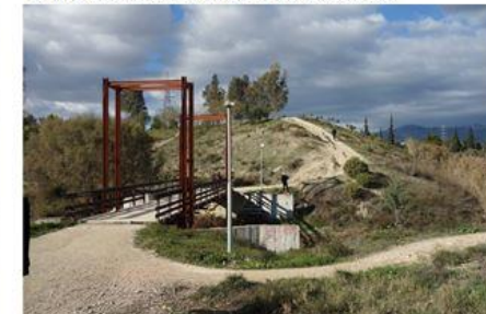
ΑΠΩΝΗ ΓΕΦΥΡΑΣ ΣΕ ΚΑΚΗ ΚΑΤΑΣΤΑΣΗ
