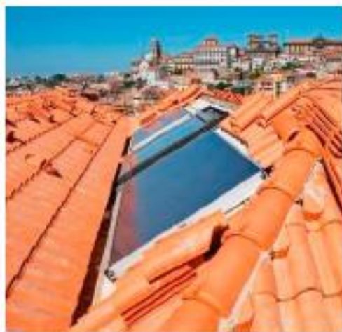
Εικόνα 12: Ενεργειακή παρέμβαση με εισαγωγή ηλιακού θερμικού πάνελ σε στέγη κτηρίου του Πόρτο
