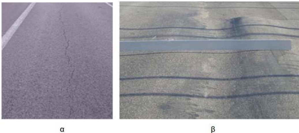
Εικόνα 2.8: Ρηγμάτωση (α) και τροχοαυλάκωση (β)
