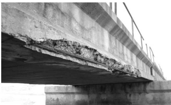
Σχήμα 1.2.1 Αποκάλυψη Οπλισμού (Spalled Concrete) λόγω διάβρωσης (αριστερά)
