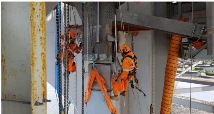
Σχήμα 1.3.1 Forth Road Bridge U.K. – Spencer Group. Αποστολή ειδικής ομάδας για επιθεώρηση
