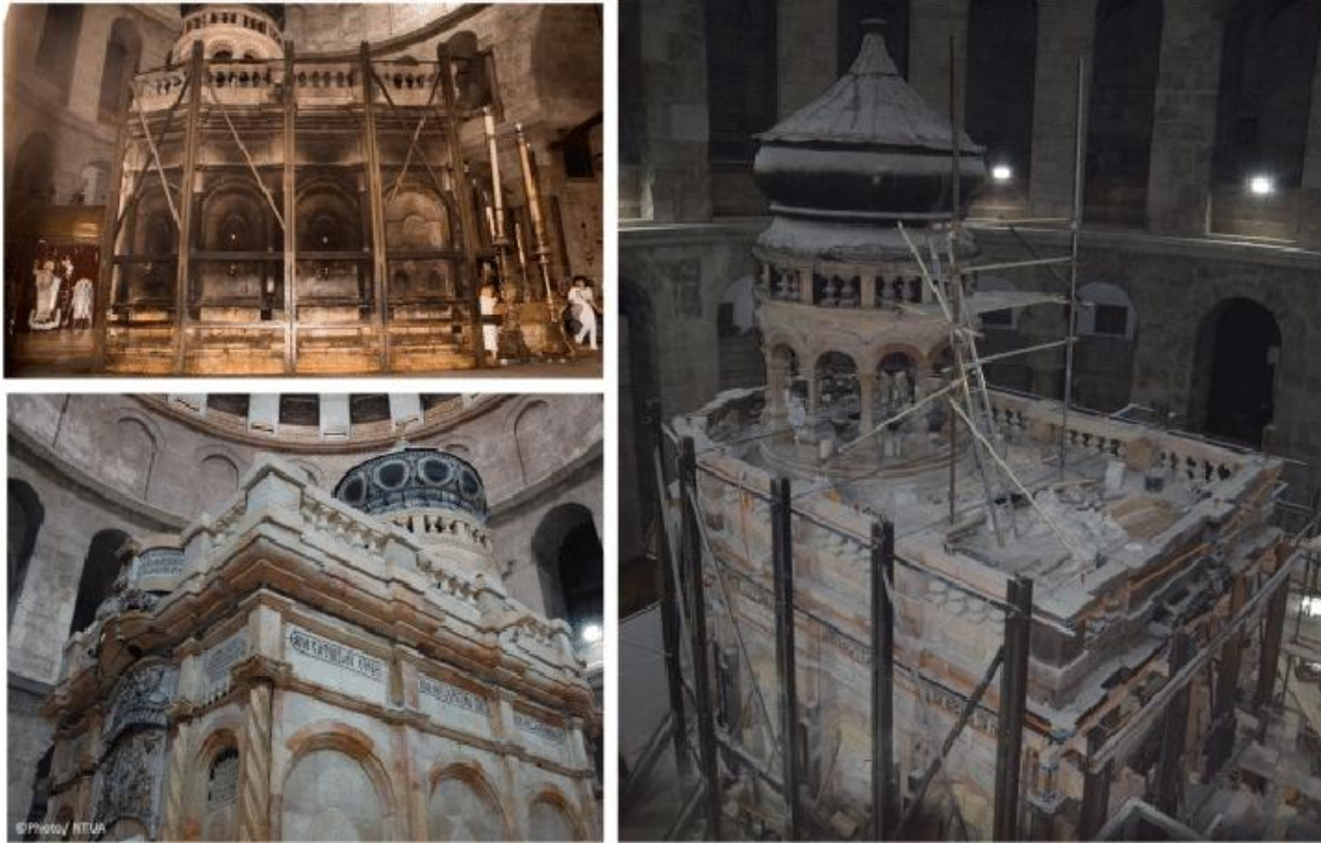
Εικόνα 3. 4: Το Ιερό Κουβούκλιο του Παναγίου Τάφου πριν (πάνω αριστερά), κατά τη διάρκεια (δεξιά) και μετά τις εργασίες αποκατάστασης (κάτω αριστερά) (Μογορούλου et al., 2018).
