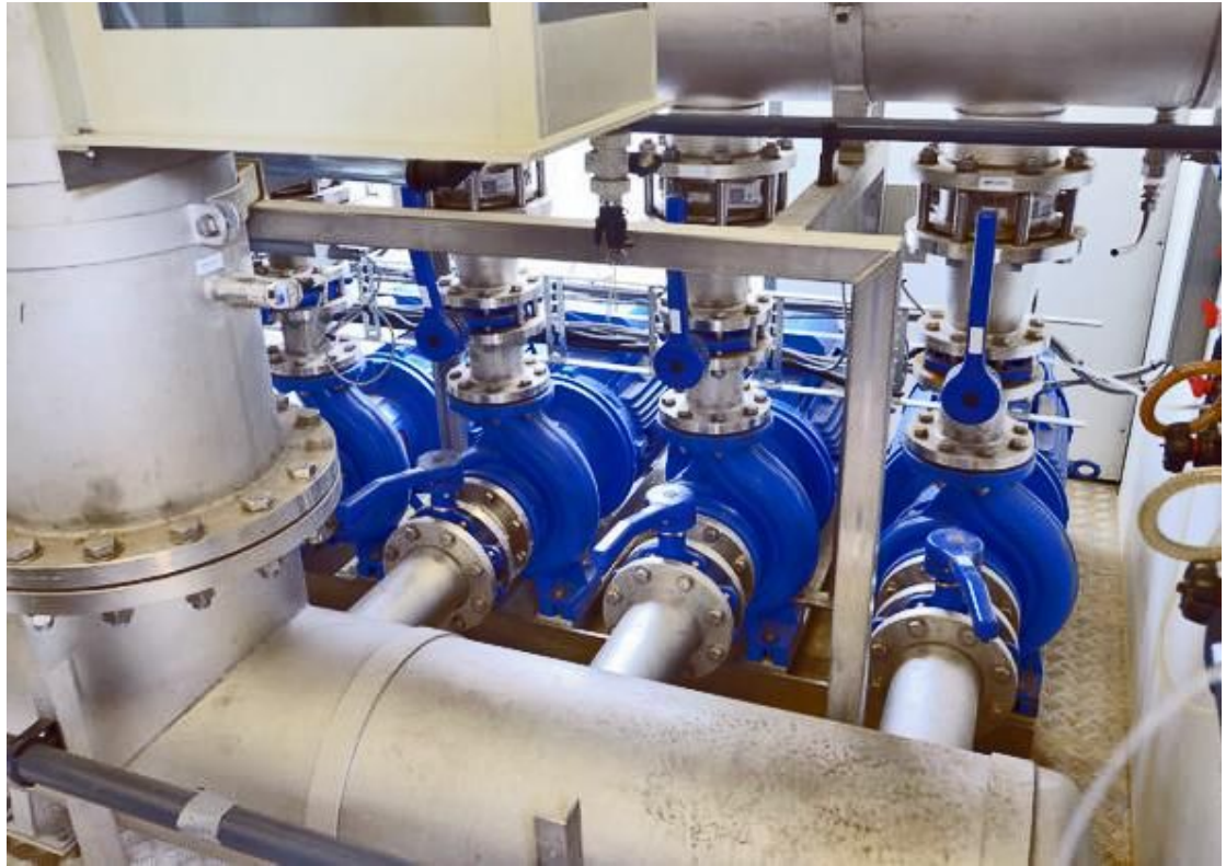
Εικόνα 43: Μονάδα αφαλάτωσης αντίστροφης ώσμωσης Αλμυρού Ποταμού Κρήτης (ΕΦΣΥΝ, 2018)
