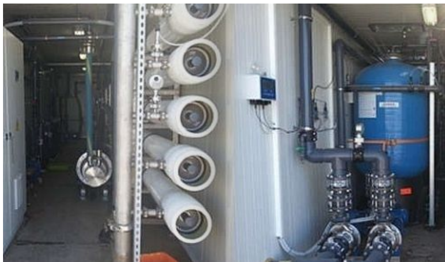
Εικόνα 38: Νέα μονάδα αφαλάτωσης αντίστροφης ώσμωσης στην Οία δυναμικότητας 2.400m 3 /ημέρα(CycladesVoice, 2018)
