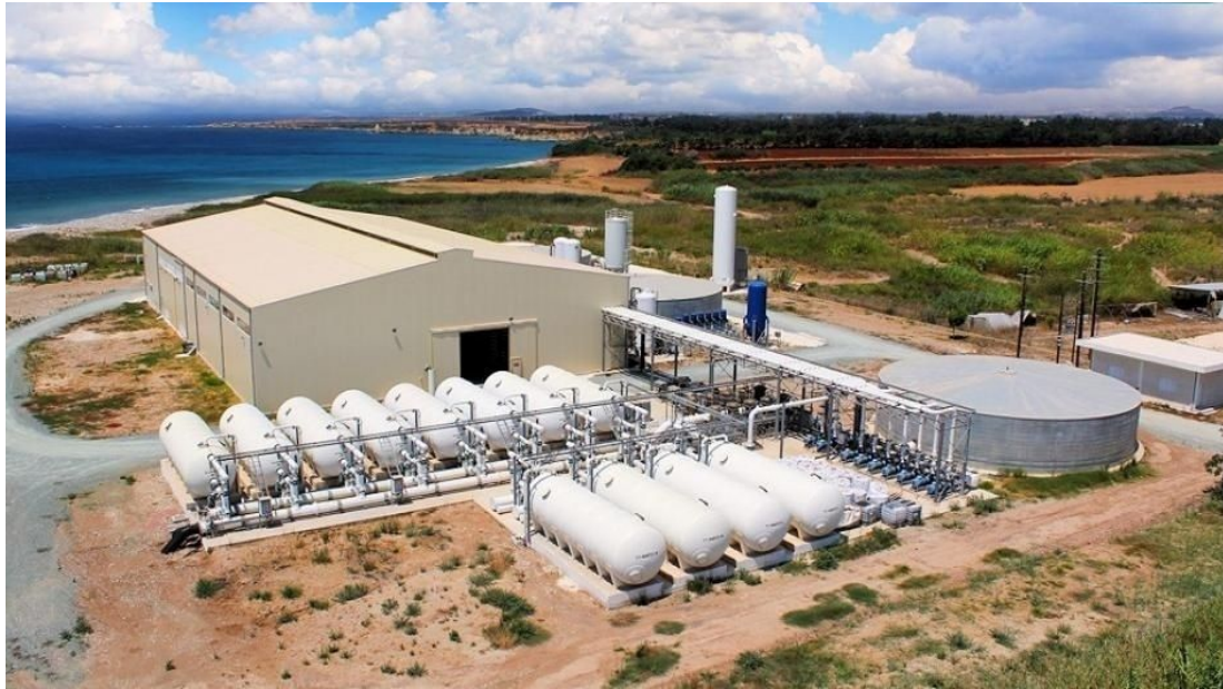
Εικόνα 40: Νέα μονάδα αφαλάτωσης αντίστροφης ώσμωσης στην Οία δυναμικότητας 2.400m 3 /ημέρα(CycladesVoice, 2018)
