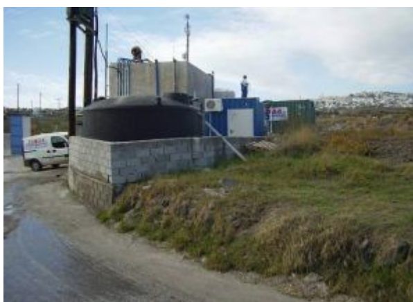
Εικόνα 39: Νέα μονάδα αφαλάτωσης αντίστροφης ώσμωσης στη Θήρα (ΤΕΜΑΚ, 2009)
