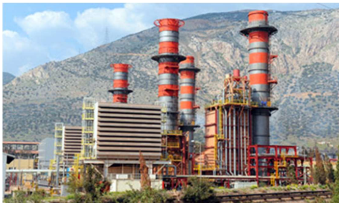
Εικόνα 5: Σταθμός συμπαραγωγής ηλεκτρισμού και θερμότητας (alhellas.com)
