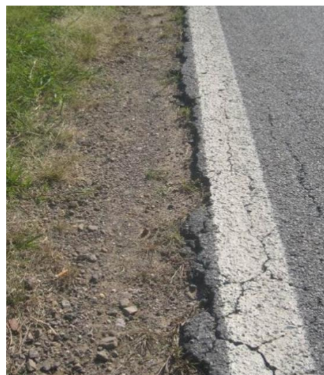
Εικόνα 20 : Ρηγμάτωση στα άκρα του οδοστρώματος
