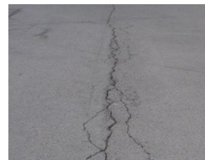
Εικόνα 17 : Χαμηλό επίπεδο φθοράς σε ρηγμάτωσεις τύπου αλιγάτορα
