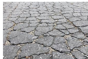
Εικόνα 19 : Υψηλό επίπεδο φθοράς σε ρηγμάτωσεις τύπου αλιγάτορα
