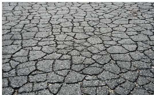
Εικόνα 16 : Ρηγμάτωσης τύπου αλιγάτορα
