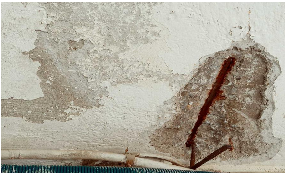
Σχήμα 3.1: Δοκός πριν την αφαίρεση του διογκωμένου σκυροδέματος.
