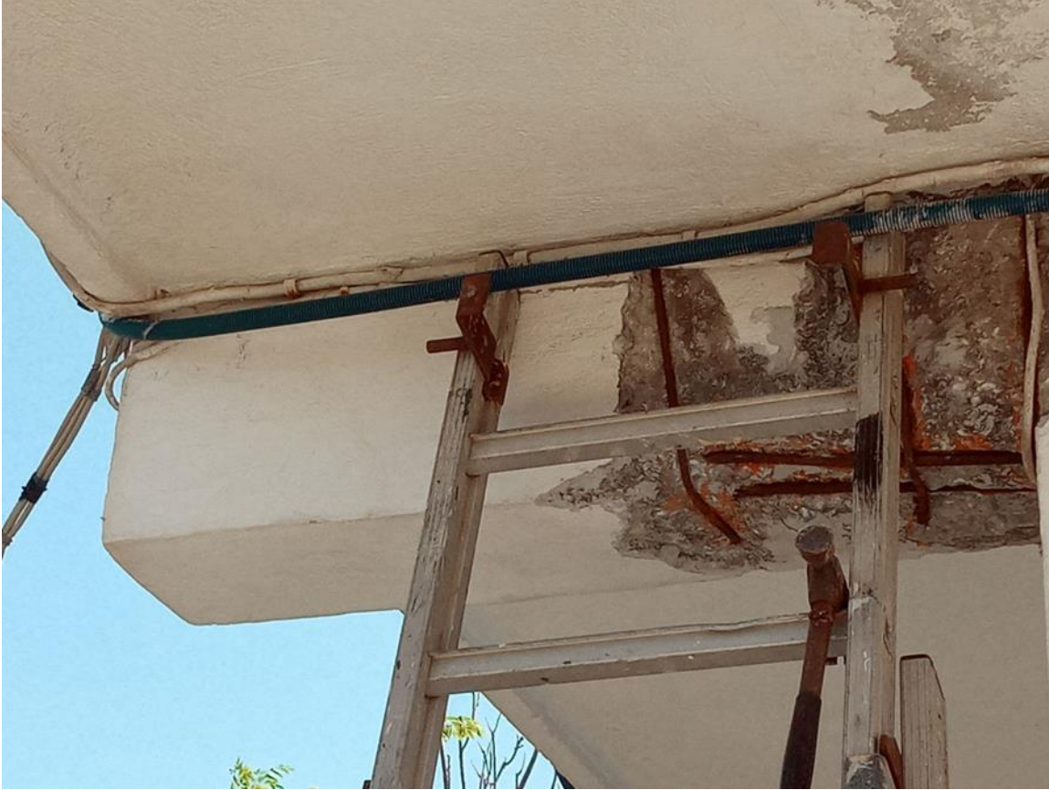
Σχήμα 3.2: Δοκός μετά την αφαίρεση του διογκωμένου σκυροδέματος.
