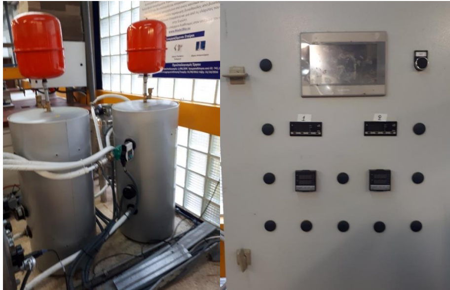
Εικόνα 21: Σύστημα θέρμανσης των βιοαντιδραστήρων (αριστερά) και κεντρικός πίνακας ελέγχου PLC (δεξιά).
