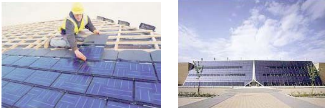
Ηλιακά κεραμίδια και εφαρμογή φωτοβολταϊκών σε πρόσοψη κτιρίου [9]
