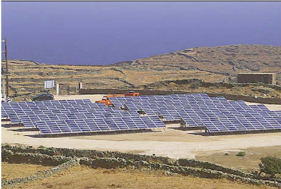
φ/β σύστημα 60 KWp στη Σίφνο (1999)
