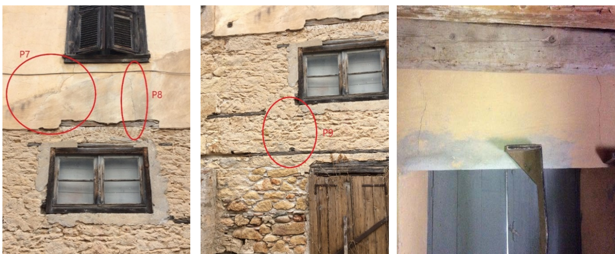
Εικόνα 3.11 - Φωτογραφική απεικόνιση ρωγμών νότιου τοίχου P7,P8,P9.
