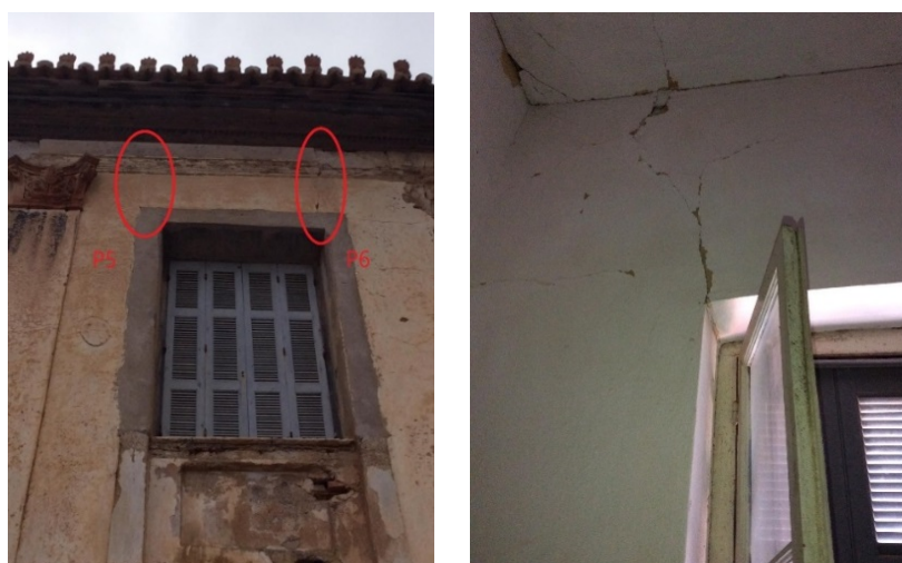
Εικόνα 3.7 - Φωτογραφική απεικόνιση ρωγμών βόρειου τοίχου P5,P6.
