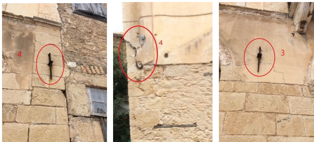
Εικόνα 2.11 - Θέση αγκύρωσης μεταλλικού στοιχείου: (α) 4 βόρεια όψη, (β) 4 νότια όψη, 3 (γ) βόρεια όψη.
