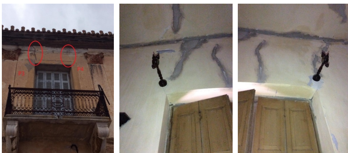
Εικόνα 3.6 - Φωτογραφική απεικόνιση ρωγμών βόρειου τοίχου P3,P4.
