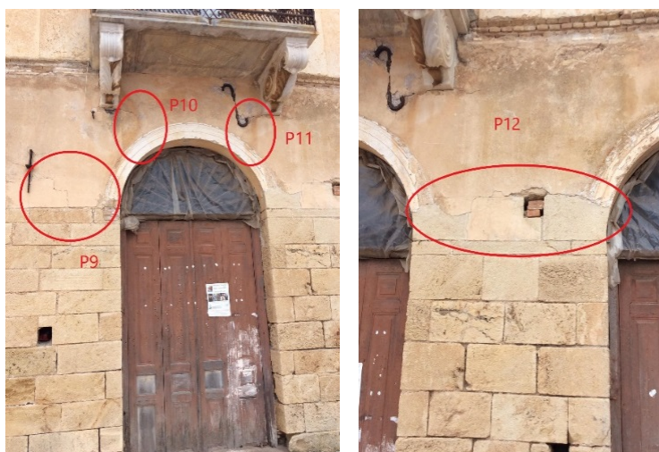
Εικόνα 3.8 - Φωτογραφική απεικόνιση ρωγμών βόρειου τοίχου P9,P10,P11,P12.
