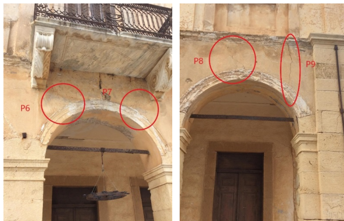
Εικόνα 3.3 - Φωτογραφική απεικόνιση ρωγμών ανατολικού τοίχου P6,7,P8,P9.
