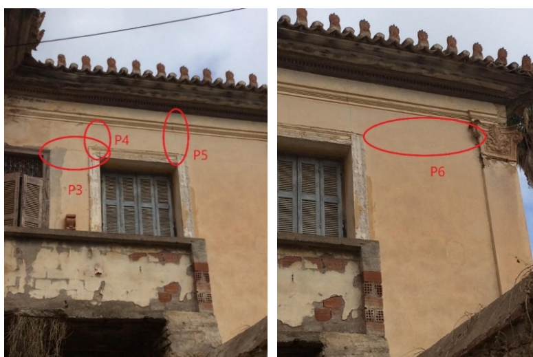
Εικόνα 3.10 - Φωτογραφική απεικόνιση ρωγμών νότιου τοίχου P3,P4,P5,P6.
