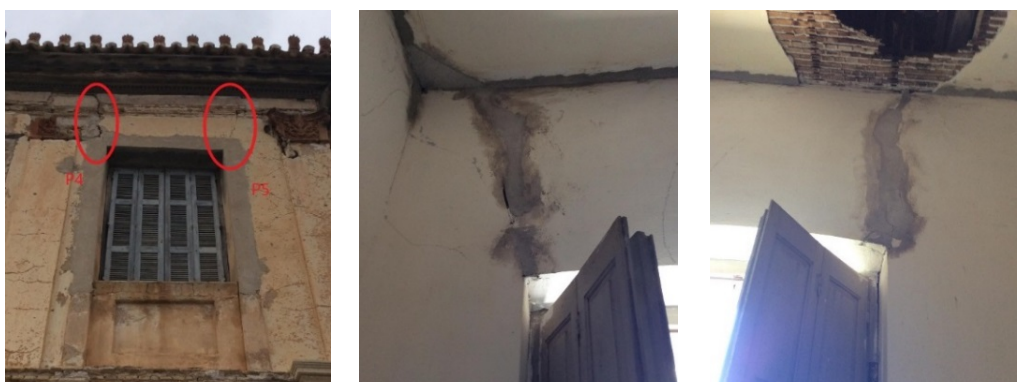
Εικόνα 3.2 - Φωτογραφική απεικόνιση ρωγμών ανατολικού τοίχου P4,5.
