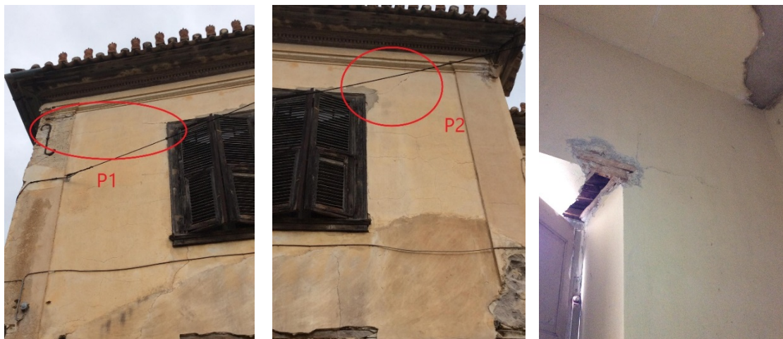
Εικόνα 3.9 - Φωτογραφική απεικόνιση ρωγμών νότιου τοίχου P1,P2.
