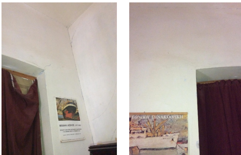
Εικόνα 3.12 - Φωτογραφική απεικόνιση ρωγμών δυτικού τοίχου P1,P2.
