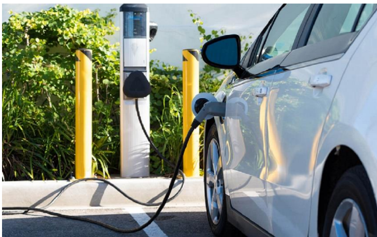
Εικόνα 61: Σημείο φόρτισης ηλεκτροκίνητου οχήματος
