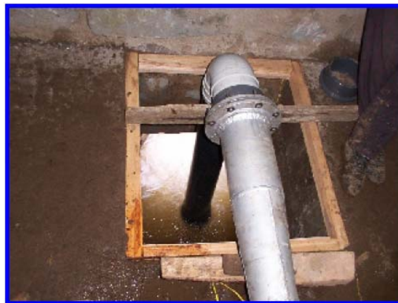
Σχήμα 3.29: Σωλήνας στην έξοδο της αντλίας
