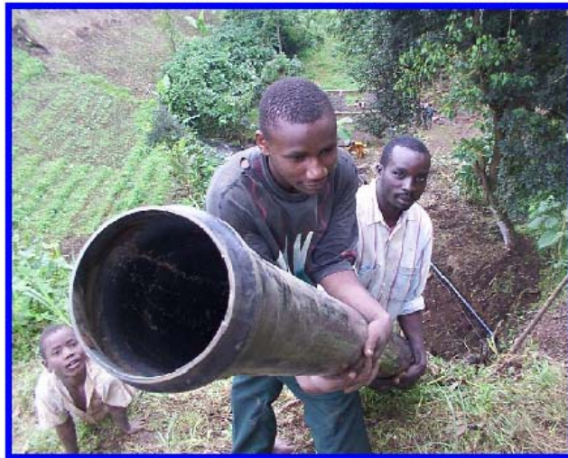
Σχήμα 3.26: Φωτογραφία τμήματος του αγωγού νερού
