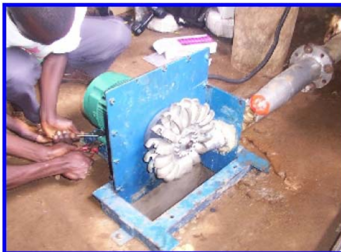
Σχήμα 3.19: Ο υδροστρόβιλος της εγκατάστασης
