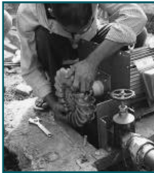
Σχήμα 3.8: Σύνδεση υδροστρόβιλου με την άτρακτο της γεννήτριας
