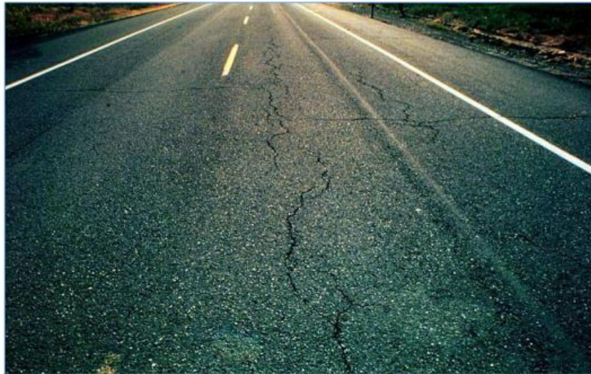
Εικόνα 3.7 Εμφάνιση ρωγμών από κόπωση στην επιφάνεια λόγω top-down cracking
