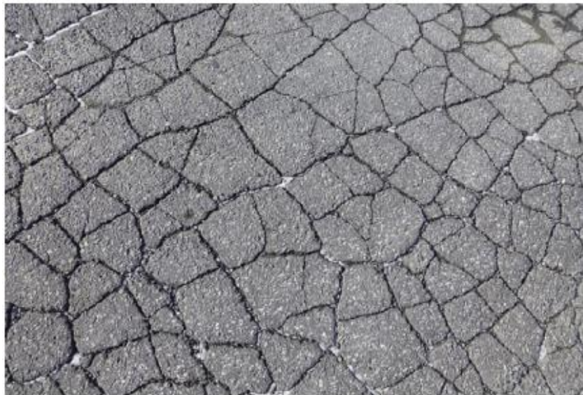
Εικόνα 3.8 Εμφάνιση αλιγατορικών ρωγμών από κόπωση στην επιφάνεια λόγω bottom-up cracking
