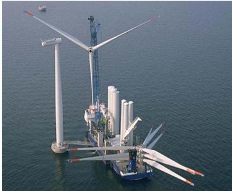
Εικόνα 5.43: Κατασκευή της πρώτης ανεμογεννήτριας στο θαλάσσιο αιολικό πάρκο Nysted της Δανίας (Πηγή: Boesen & Corlin, 2006)
