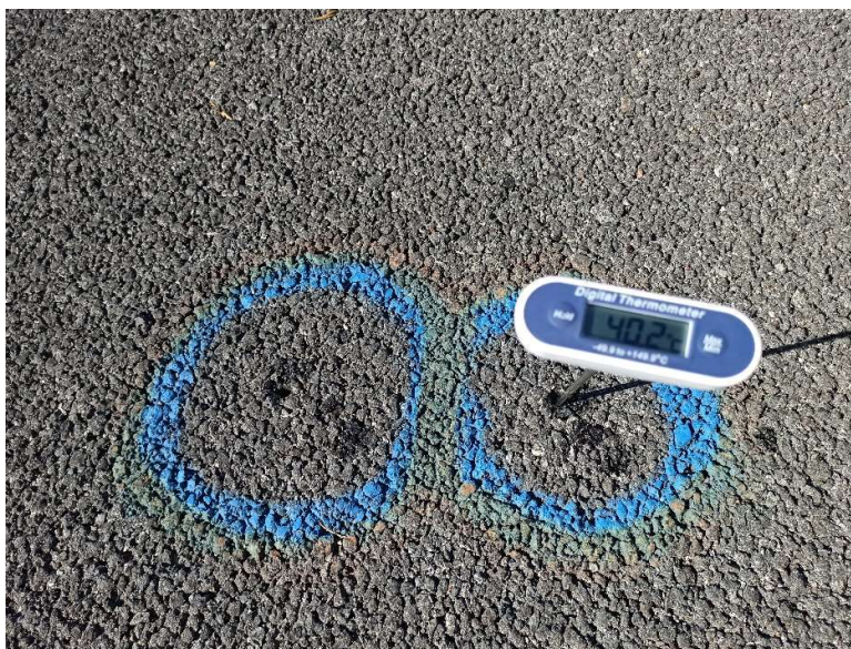
Εικόνα 8.15: Καταγραφή υψηλής θερμοκρασίας στο εσωτερικό των ασφαλτικών στρώσεων σε τμήμα ελληνικού αυτοκινητοδρόμου.
