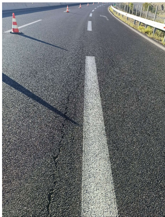
Εικόνα 8.28: Διαμήκης ρωγμή στην επιφάνεια του οδοστρώματος στη θέση ελέγχου VI4.
