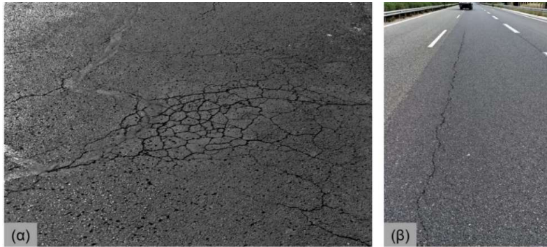
Εικόνα 2.16: (α) Αλιγατορικές ρωγμές (bottom-up cracking) και (β) διαμήκης ρωγμή (top-down cracking).
