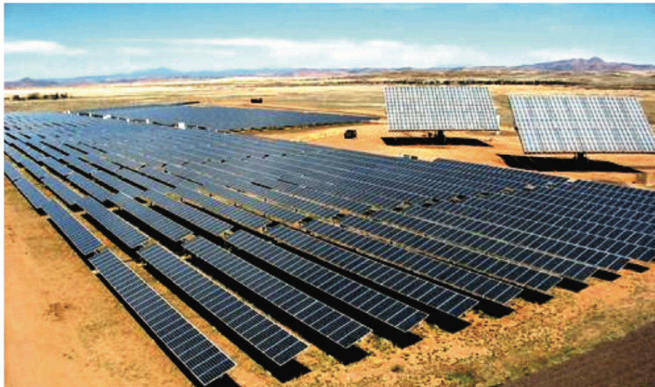
Εικόνα 6.1: Παρουσίαση φωτοβολταϊκής εγκατάστασης
