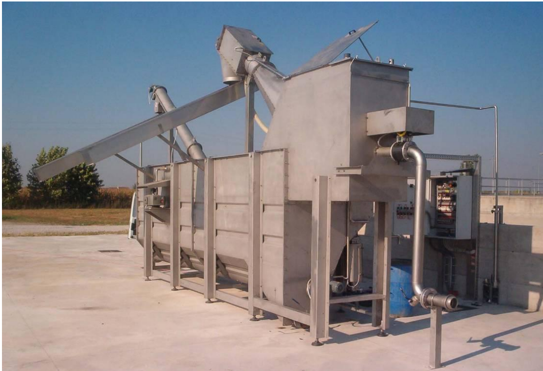
Εικόνα 6 : Μονάδα προεπεξεργασίας λυμάτων (DEVISE ENGINEERING A.E.)
