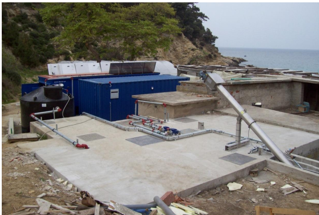
Εικόνα 8 : Εικόνα εγκατάστασης κατά την κατασκευή (DEVISE ENGINEERING A.E)
