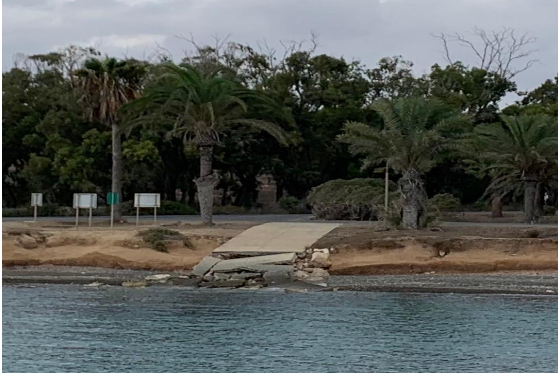
Εικόνα 5-20: Διαβρωμένη ράμπα στο καταφύγιο Ξυλοτύμπου (Πηγή: Προσωπικό αρχείο).
