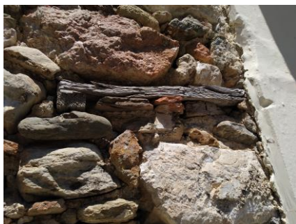
Εικόνα Β48 Σύνδεση τοίχου ΝΔ όψης με τη μεσοτοιχία μέσω ξύλινων ενισχύσεων καθ' ύψος
