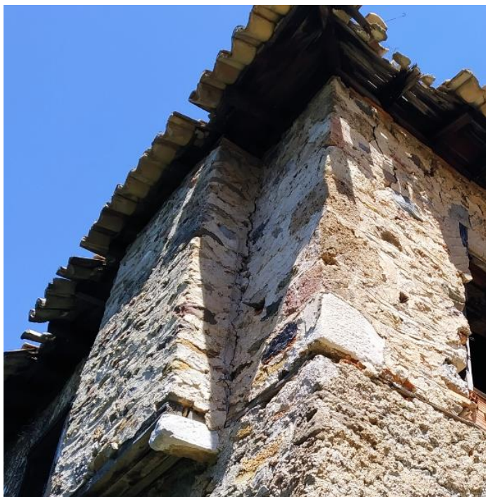
Εικόνα Β96 Ρωγμή στη σύνδεση της εστίας και φθορά ξύλινου γείσου
