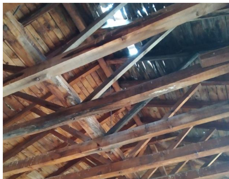
Εικόνα Β97 Βλάβη στην στέγη της πτέρυγας Β΄
