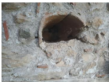
Εικόνα B27 Εξωτερική οπή στην τοιχοποιία
