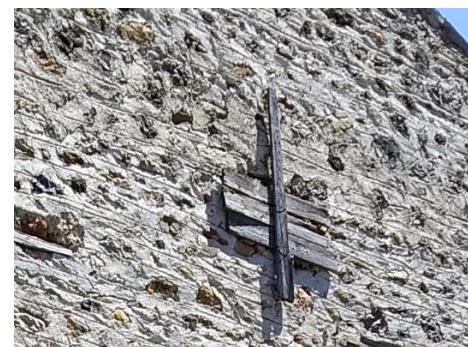
Εικόνα B71 Θέση πιθανής αγκύρωσης χαλύβδινης δοκού
