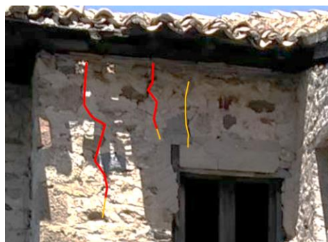
Εικόνα Β92 Ρηγμάτωση σε υπέρθυρο ΝΔ όψης της πτέρυγας Β'
