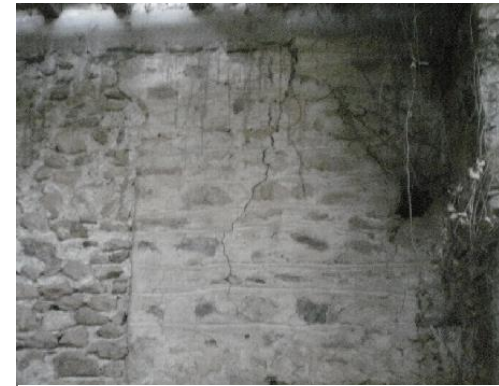
Εικόνα Β95 Ρωγμή στη στάθμη μεσοπατώματος της πτέρυγας Β'
