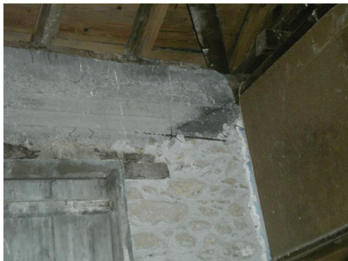
Εικόνα Β74 Εμφανής διαμήκης σπλισμός σε διάζωμα ω.σ. της πτ. Α΄
