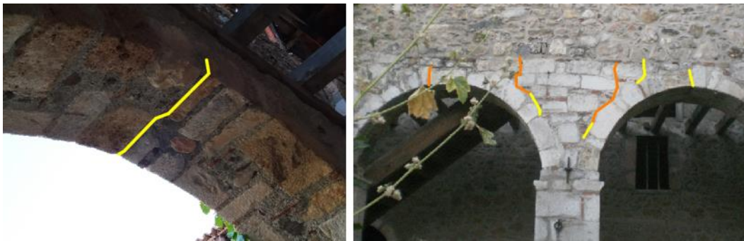
Εικόνα Β94 Ρωγμές στην τοξοστοιχία
