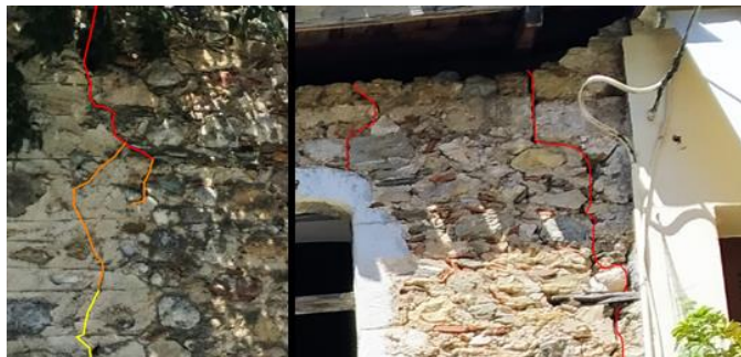
Εικόνα Β91 Κατακόρυφες ρωγμές ΝΔ όψης στην πτέρυγα Α'
