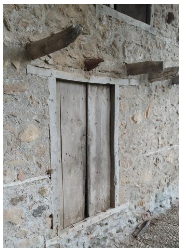
Εικόνα B26 Ξύλινο κούφωμα της πτ. Β' και εν προβόλω δοκοί
