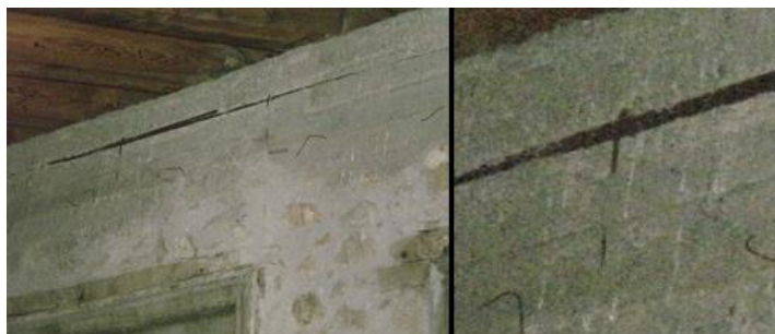
Εικόνα Β73 Εμφανής διαμήκης σπλισμός σε διάζωμα ω.σ. της πτ. Α΄
