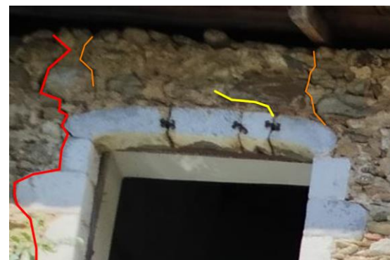
Εικόνα Β9ο Ρηγματωμένο υπέρθυρο ΝΔ όψης πτέρυγας Α'
