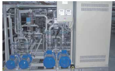
Σύστημα ψύξης του μετατροπέα
