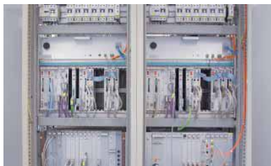
Πίνακας ελέγχου του συστήματος ώθησης
