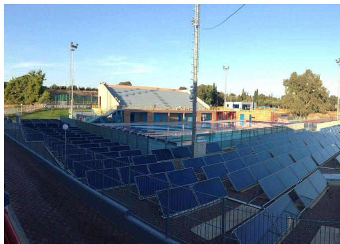
Εικόνα 3.6: Συλλέκτες 270m^2 για θέρμανση κολυμβητηρίου 7.000lt στην Αμαλιάδα [18]
