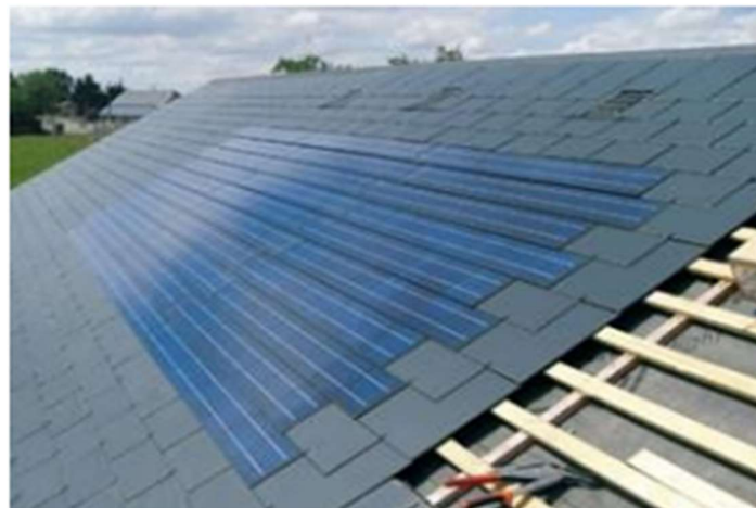
Εικόνα 8.7: Οργανικά φωτοβολταϊκά σε σκεπή κτιρίου [74]
