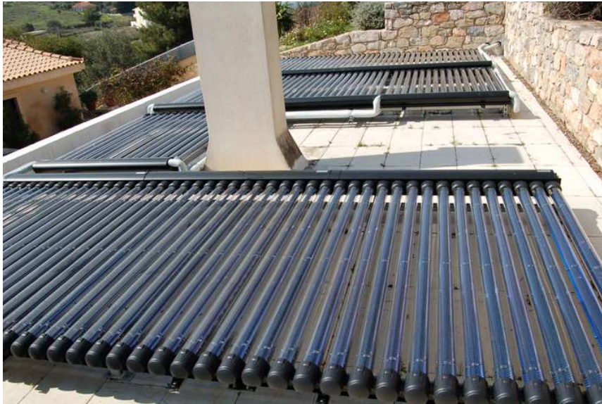
Εικόνα 3.9: Συλλέκτες κενού για θέρμανση νερού σε πισίνα [21]
