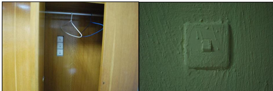
Εικόνα 4.10. Παραδείγματα κακοτεχνιών. Διακόπτες μέσα σε ντουλάπα (αριστερά), αχρηστευμένος διακόπτης (δεξιά).
