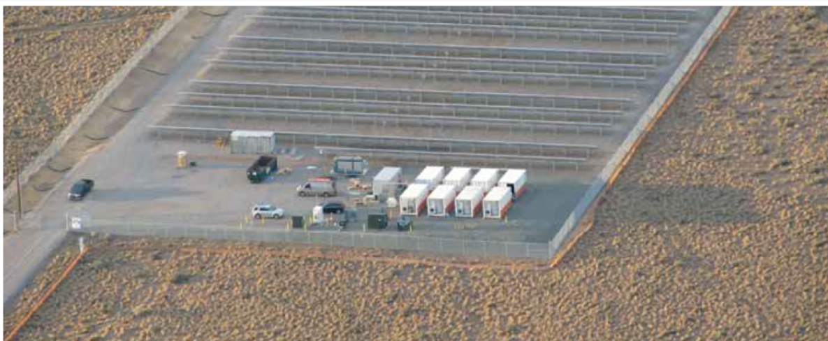
Εικόνα 3-5: Μπαταρίες στο έργο αποθήκευσης ενέργειας Prosperity στο Νέο Μεξικό
