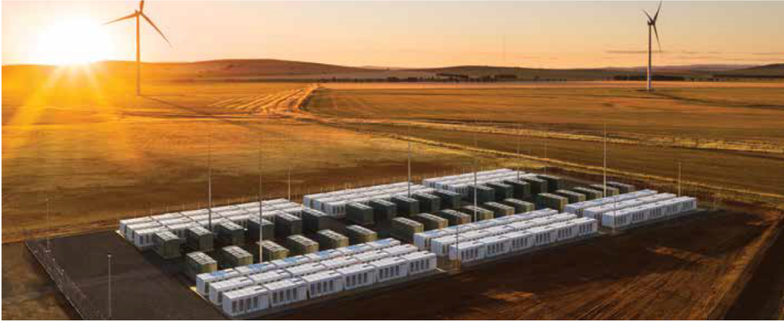
Εικόνα 3-3: Hornsdale Power Reserve στη Νότια Αυστραλία
