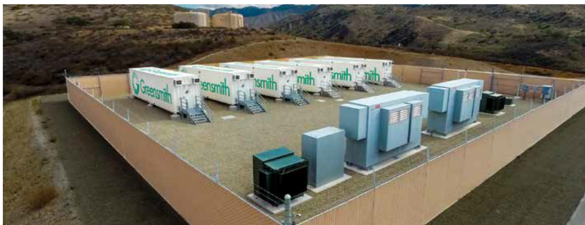
Εικόνα 3-8: Σύστημα αποθήκευσης μπαταριών της Greensmith για αναβολή διανομής στην Καλιφόρνια
