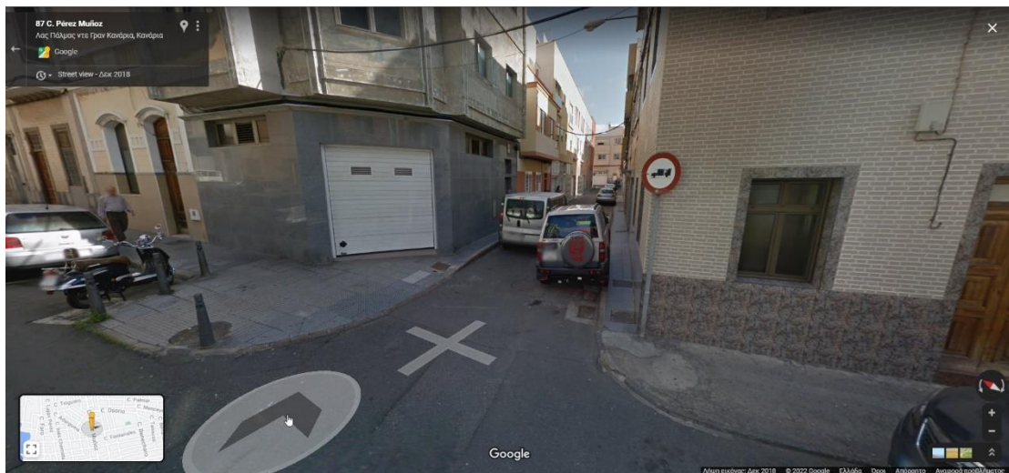
Εικόνα 3.53: Παράδειγμα σύνδεσης πεζοδρομίων με μια ράμπα σε κακή κατάσταση όπου η C1_4=1 στην πόλη Λας Πάλμας (Πηγή: Google Street View)
