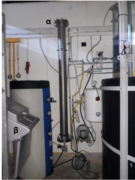
Εικόνα 4-16: (α) Στήλη αφύγρανσης του βιοαερίου και (β) συμπιεστής βιοαερίου
