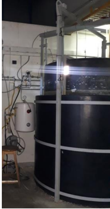
Εικόνα 4-15: Κυλινδρικό αεριοφυλάκιο με σύστημα πλωτής οροφής, χωρητικότητας 2 m 3
