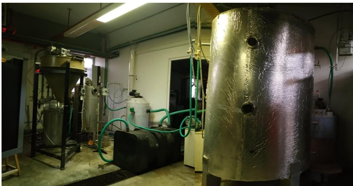
Εικόνα 4-13 Ημι-βιομηχανική μονάδα διβάθμιου συστήματος αναερόβιας χώνευσης
