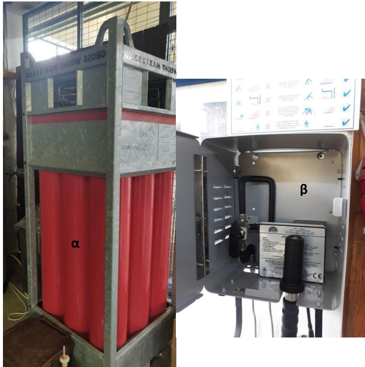
Εικόνα 4-17: (α) Δοχεία αποθήκευσης συμπιεσμένου υθανίου και (β) σταθμός τροφοδοσίας απορριμματοφόρων με βιοαέριο
