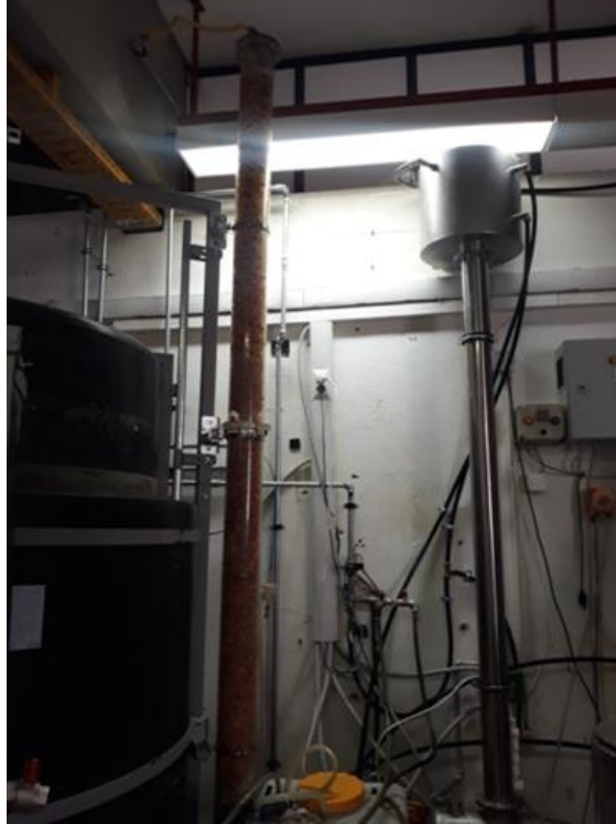
Εικόνα 4-14: Στήλη απορρόφησης διοξειδίου του άνθρακα και θειούχων ενώσεων
