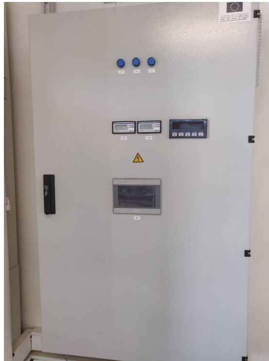
Εικόνα 4-12: Πίνακας ελέγχου (PLC) πειραματικής κλίμακας διβάθμιου συστήματος συστήματος αναερόβιας χώνευσης
