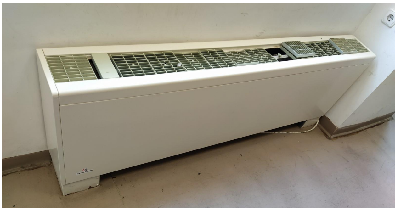
Εικόνα 26: FAN COIL UNIT
