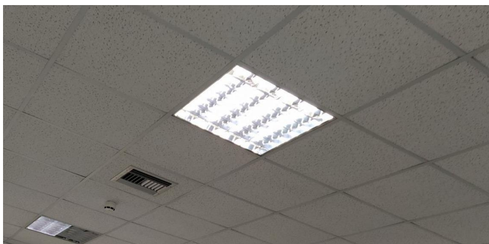
Εικόνα 21: Εγκατεστημένα Φωτιστικά Σώματα T5 4x12W
