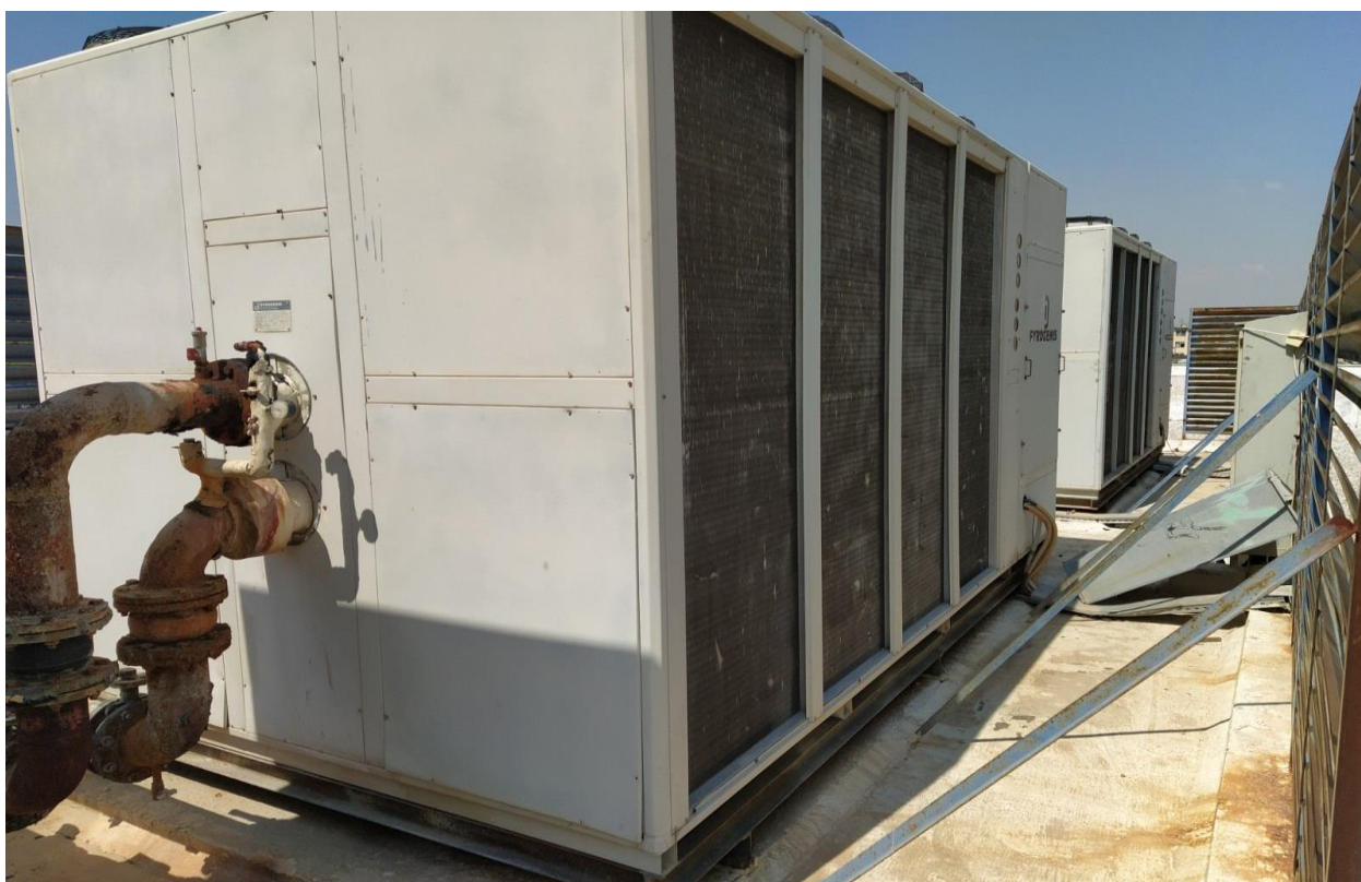
Εικόνα 24: Αντλίες Θερμότητας FYROGENIS FAWH 2150-SH
