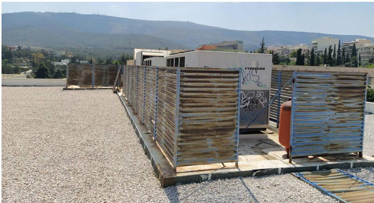
Εικόνα 23: Αντλίες Θερμότητας FYROGENIS FAWH 2150-SH
