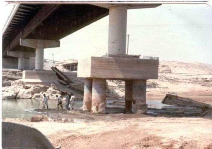
Εικόνα 77 – Γέφυρα θεμελιωμένη σε πασσάλους που έχει υποστεί υποσκαφή
