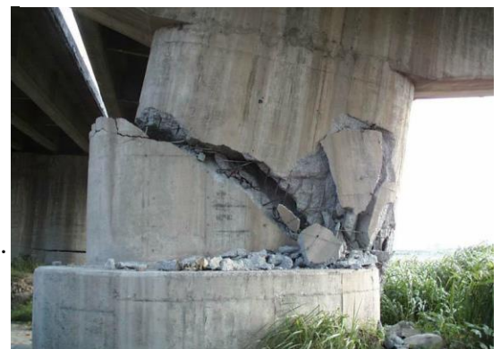
Εικόνα 13 – Διατμητική αστοχία βάθρου γέφυρας Dauktani, στο Yabani, Ιαπωνία 2011
