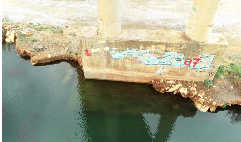
Εικόνα 81 – Υποσκαμμένο έδαφος στο βάθρο γέφυρας Γεροποτάμου
