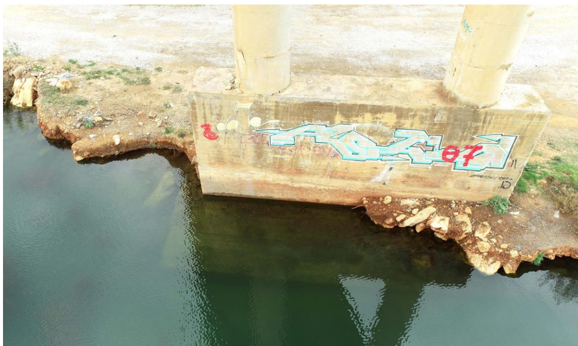
Εικόνα 28 – Βάθρο 4 ο κατά σειρά με το έδαφος περίξ αυτού να έχει δεχθεί υποσκαφή
