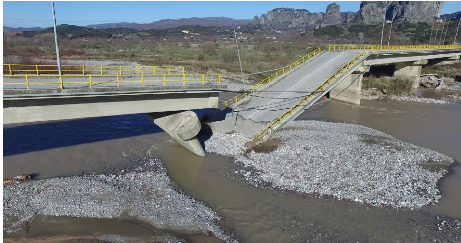
Εικόνα 78 – Κατάρρευση γέφυρας Διάβας λόγω υποσκαφής
