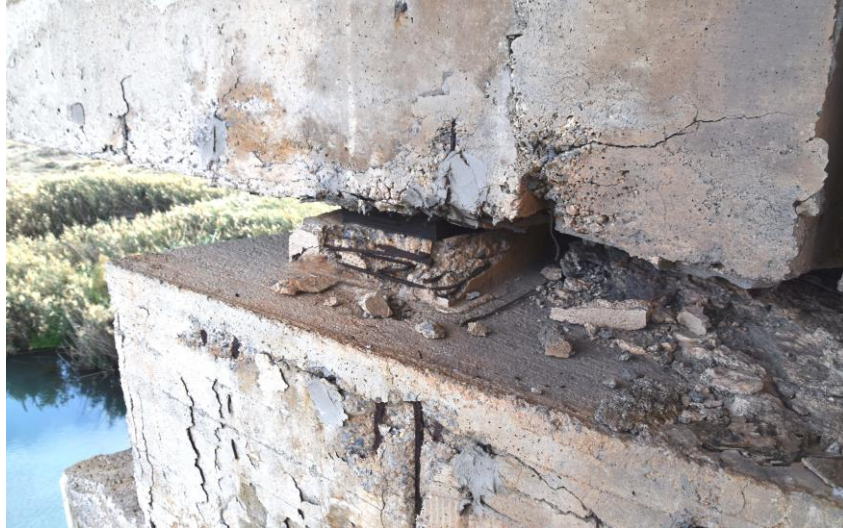
Εικόνα 25 – Αποδιοργανωμένη εικόνα των πλίνθων έδρασης με αποκάλυψη και οξείδωση των οπλισμών τους
