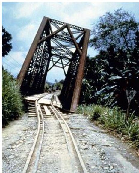
Εικόνα 14 – Υποχώρηση θεμελίωσης σε σιδηροδρομική γέφυρα
