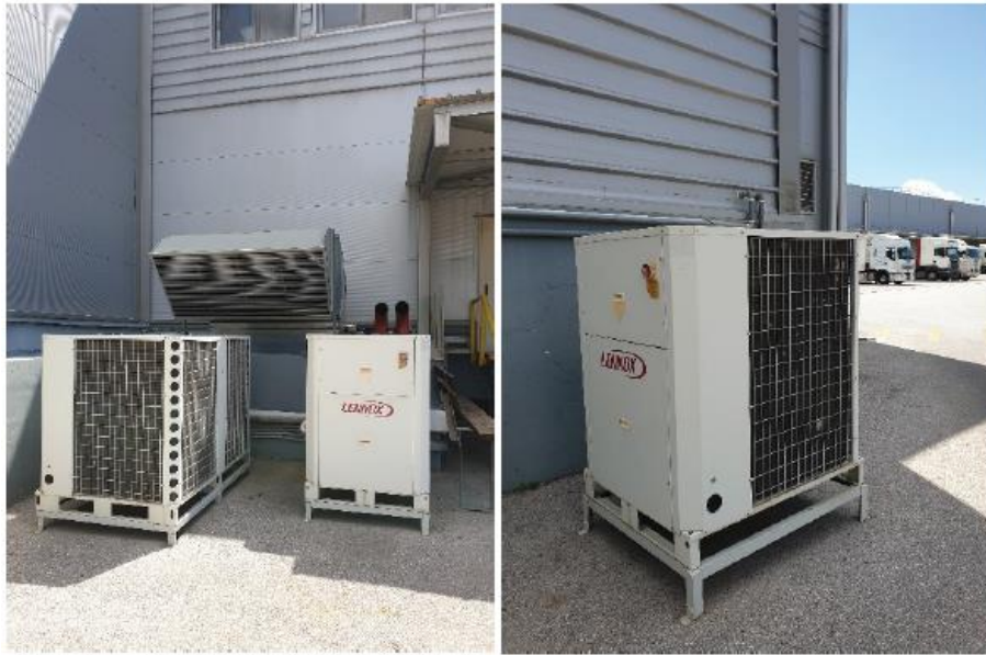
Εικόνα 8: Εξωτερικές μονάδες κλιματισμού
