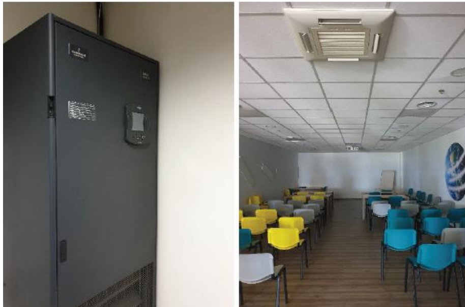
Εικόνα 9: Εσωτερική Μονάδα Κλιματισμού Data Room (αριστερά) & Εσωτερική Κασέτα Χώρου Συνεδριάσεων (δεξιά).
