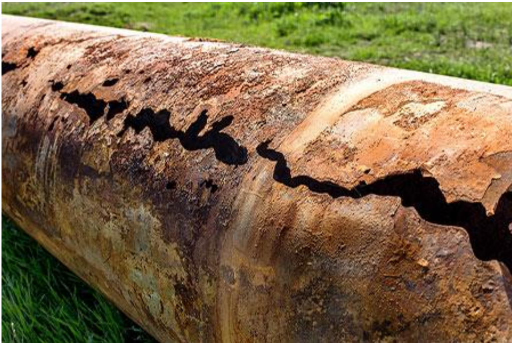
Εικόνα 2.21 : Θαλάσσιος αγωγός ο οποίος εμφάνισε θραύση εξαιτίας της διάβρωσης.
