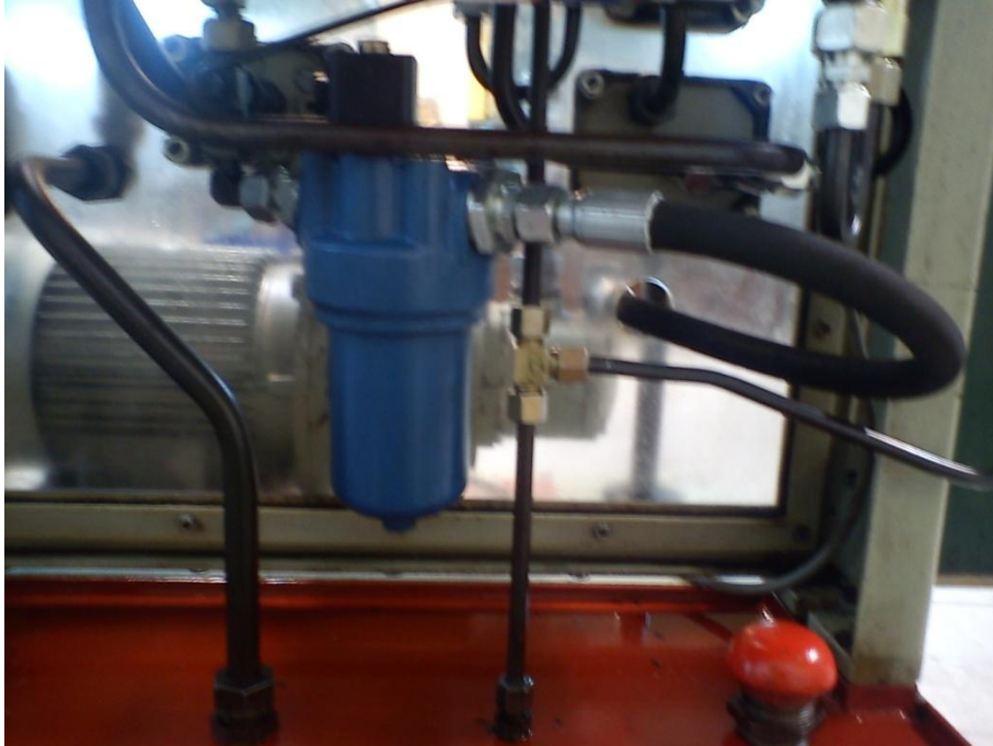
Εικόνα 4.34: Σημείο τοποθέτησης φίλτρου πίεσης στο υδραυλικό κύκλωμα Herion.
