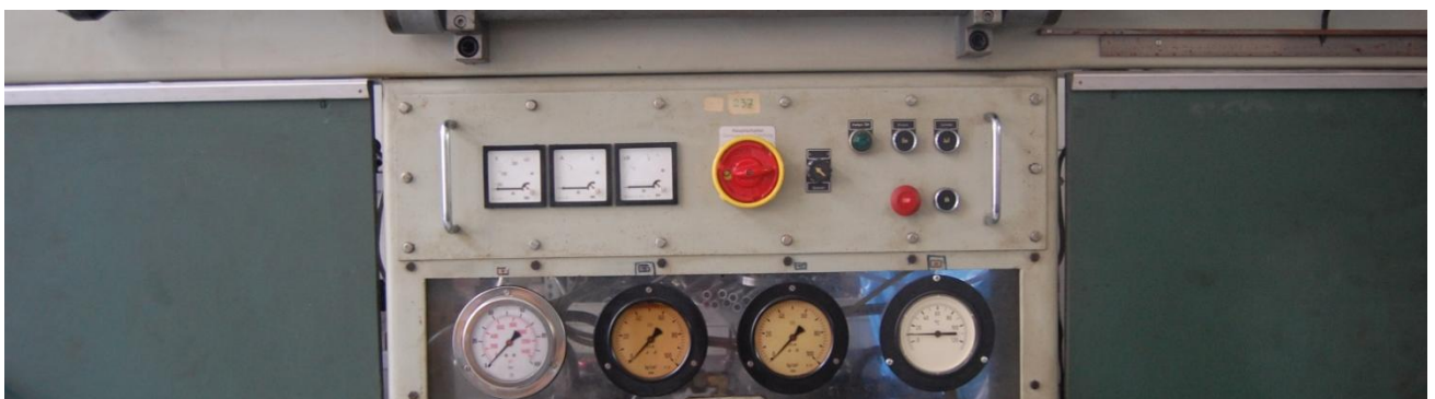
Εικόνα 4.41: Κεντρική ηλεκτρολογική εγκατάσταση της υδραυλικής μηχανής Herion.
