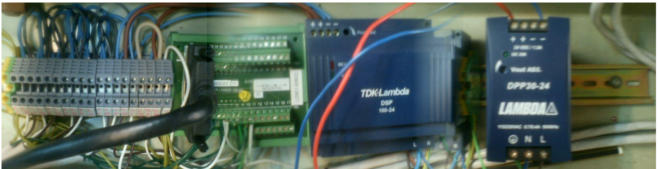
Εικόνα 4.42: Νέα πρόσθετη ηλεκτρολογική εγκατάσταση της υδραυλικής μηχανής Herion.
