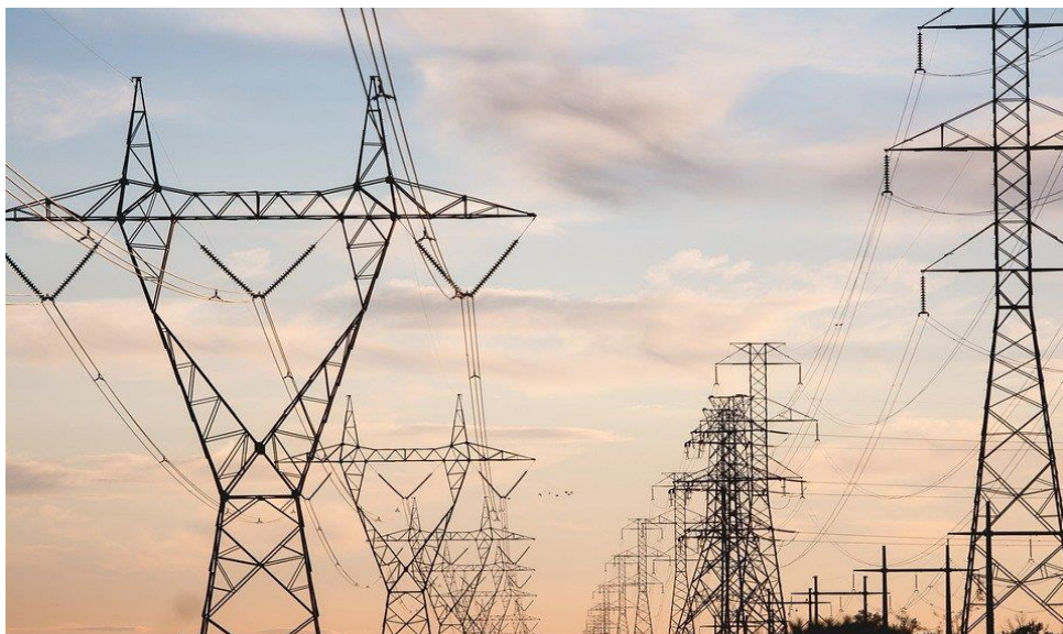
Εικόνα 10. Εναέριες γραμμές ηλεκτρικού ρεύματος υψηλής τάσης κατασκευασμένες από αλουμίνιο
