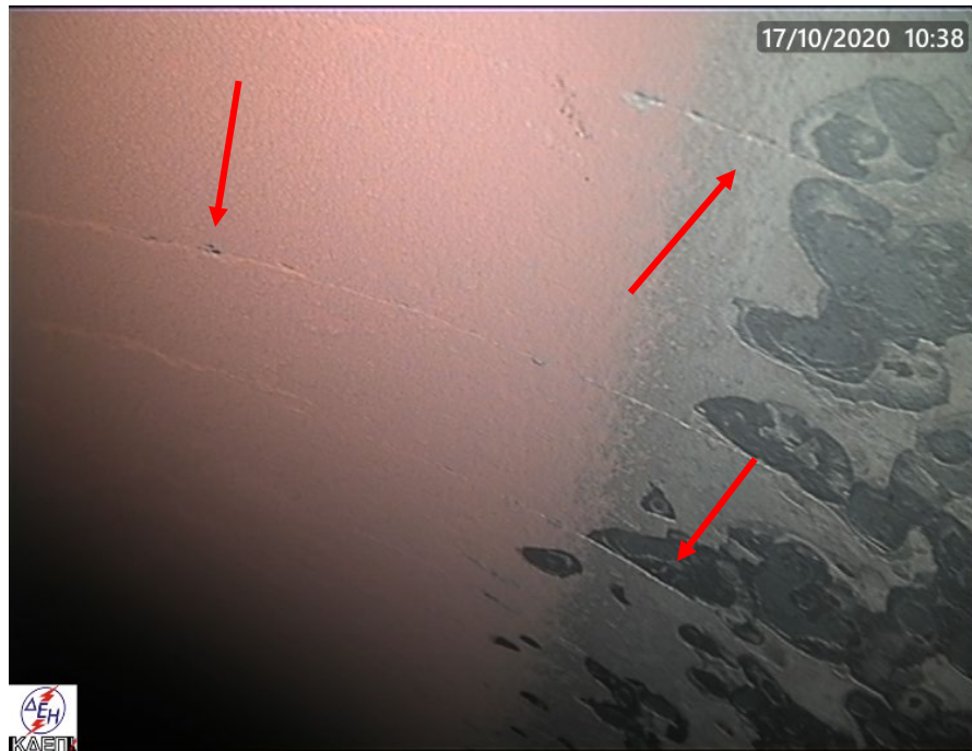
Εικόνα 3.18: Παρατήρηση ρωγμών με ενδοσκόπιο
