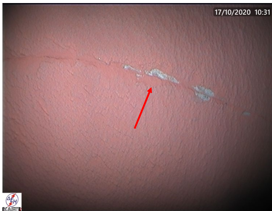
Εικόνα 3.19: Παρατήρηση ρωγμής με ενδοσκόπιο
