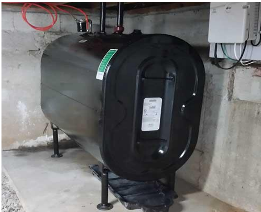
Σχήμα 30. Δεξαμενή πετρελαίου θέρμανσης οικιακή χρήσης [27].
