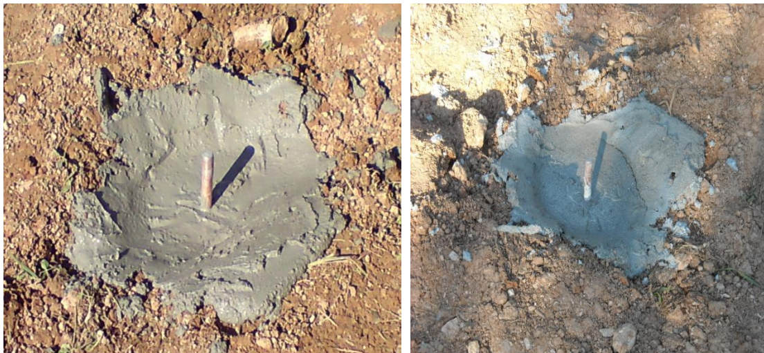
Εικόνα 5.3: Ηλεκτρόδια γείωσης εμβαπτισμένα σε μπετονίτη και σκυρόδεμα
