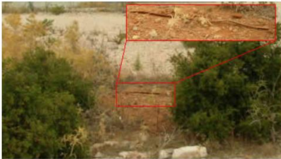
Εικόνα 3.1: Περιμετρικό ηλεκτρόδιο γείωσης σκεπασμένο με χώμα.
