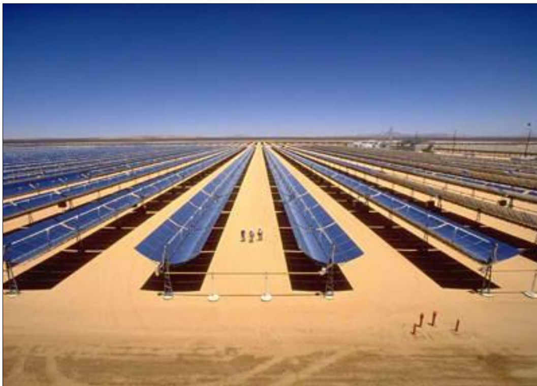
Σχήμα 2.1 Ηλιοθερμικός σταθμός με τεχνολογία παραβολικών κατόπτρων
