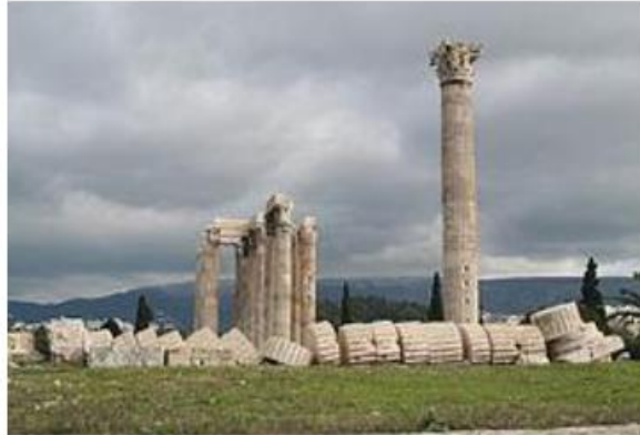
Σχήμα 5.4 Ανατροπή ελεύθερα εδραζόμενων υποστυλωμάτων μετά από σεισμό.
