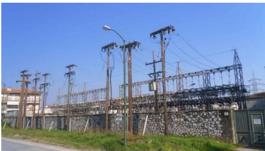
Εικόνα 19. Υποσταθμός υποβιβασμού ΥΤ/ΜΤ
