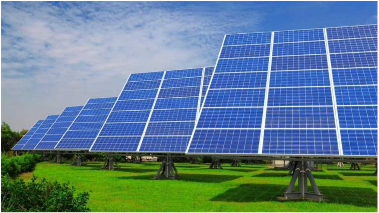
Εικόνα 7. Φωτοβολταϊκό πάρκο με σύστημα ιχνηλάτησης διπλού άξονα
