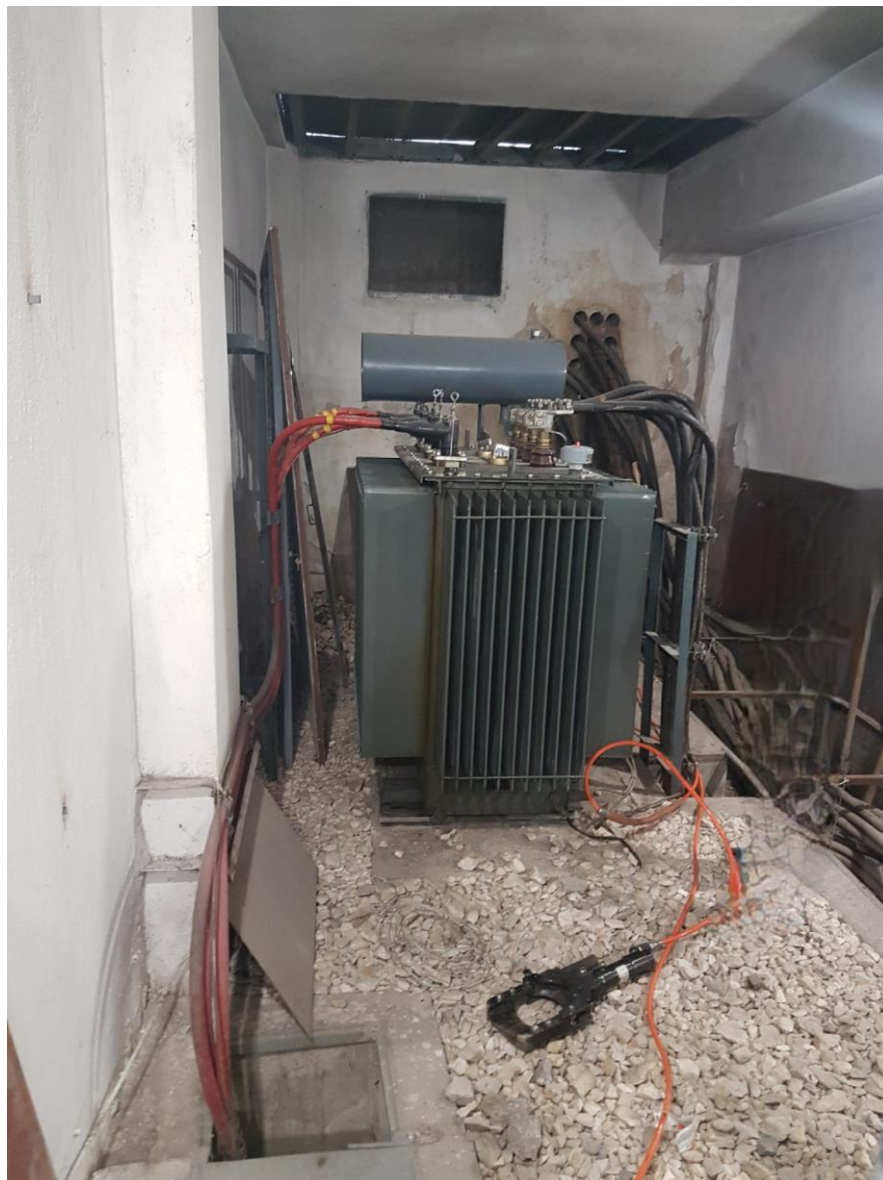
Εικόνα 22. Μ/Σ σε υπόγειο Υ/Σ στην πόλη των Σερρών
