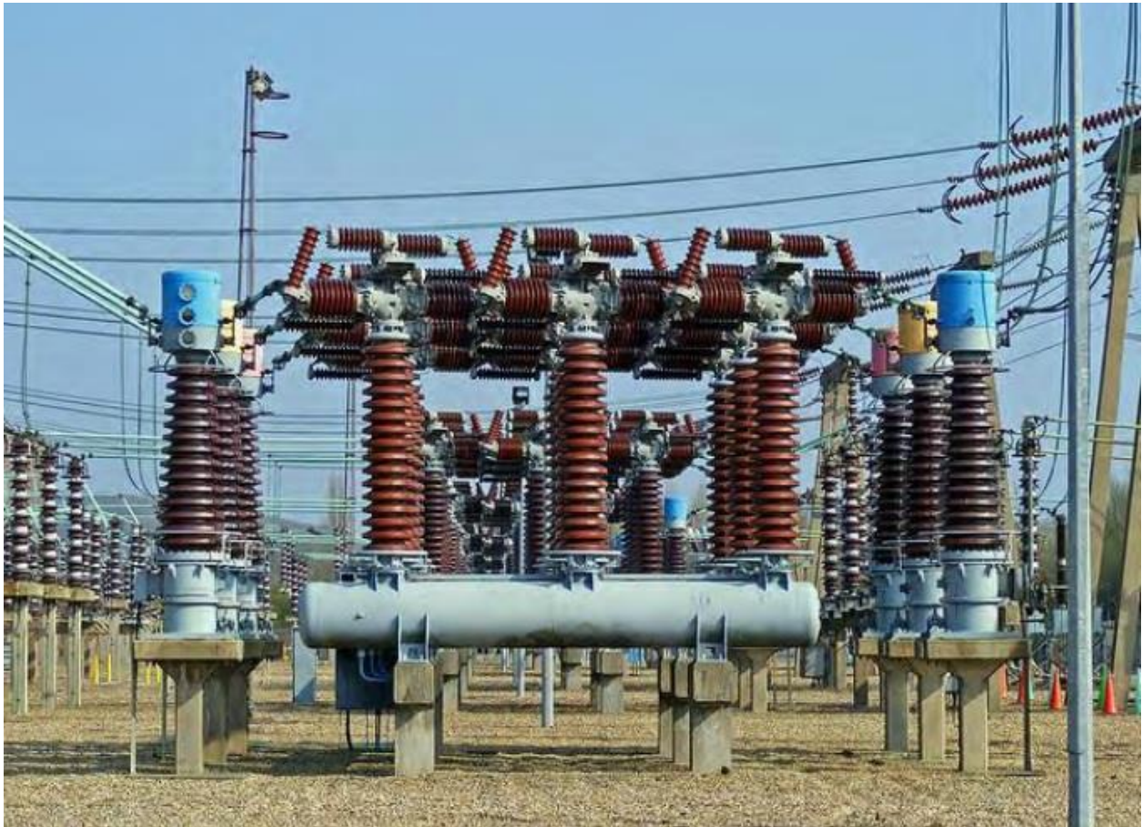
Εικόνα 41. Δ/Ι πεπιεσμένου αέρα 275kV [24]
