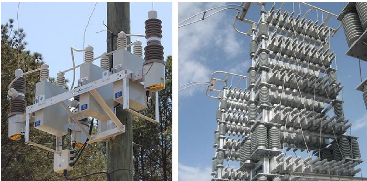
Εικόνα 53. Πυκνωτές αντιστάθμισης εγκατεστημένοι σε στύλο (αριστερά) και σε ζυγό ΜΤ (δεξιά)
