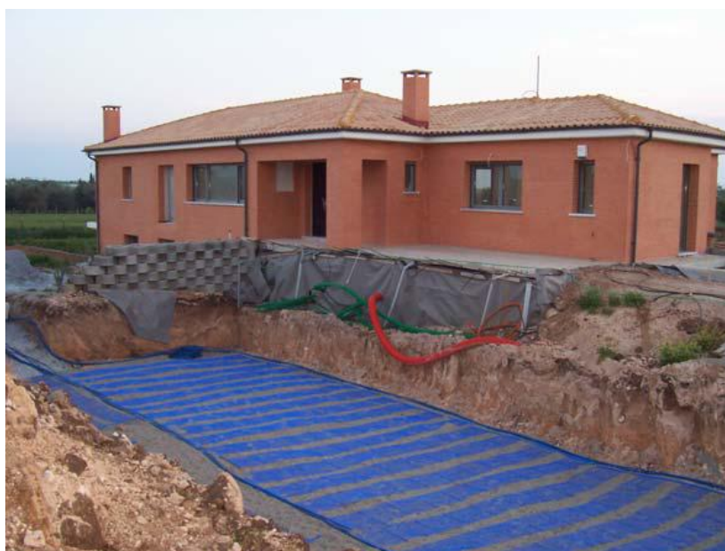
Εικόνα 13 : Χρήση συστήματος γεωθερμικής αντλίας θερμότητας (τοποθέτηση οριζόντιου κλειστού κυκλώματος γεωεναλλάκτη) για την κάλυψη θερμικών αναγκών μονοκατοικίας 220 m 2 στην περιοχή Αγγελοχωρίου Θεσ/νίκης (στάδιο κατασκευής και ανάπτυξης)
