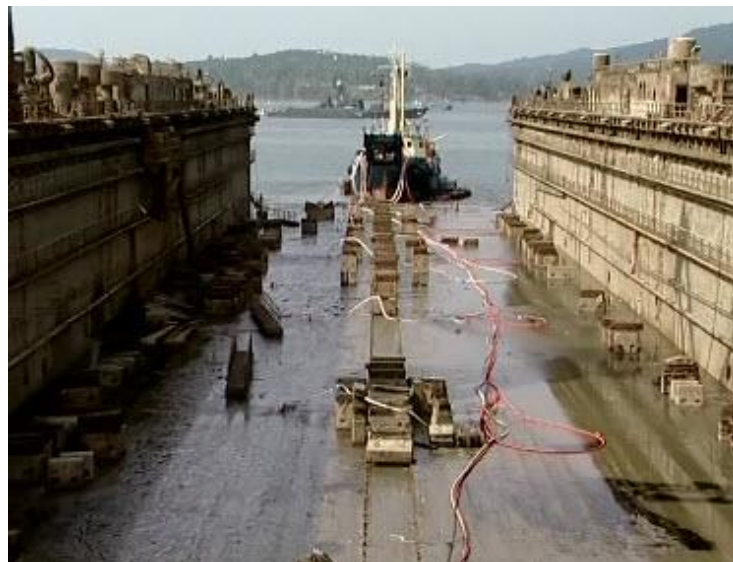
Σχήμα 5.33: Η στιγμή που όλη η δεξαμενή είναι στο επιθυμητό βύθισμα και θα επιβιβαστεί σε αυτή προσωπικό για να την καθαρίσει από την λάσπη (52).
