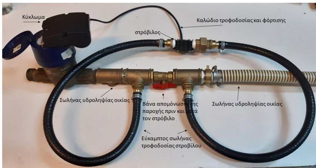
Σχήμα 4.4: Αναβάθμιση φρεατίου οικιακού μετρητή σε dummy φρεάτιο εγκατάστασης LA/LG (Η εικόνα είναι ενδεικτική δεδομένου ότι αναφέρεται στην αναβάθμιση υφιστάμενου μηχανικού υδρομετρητή σε smart water meter με την προσθήκη κεφαλής ανάγνωσης της ένδειξης)
