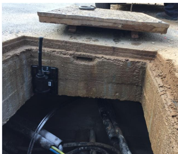
Σχήμα 4.9: Εικόνα από την εγκατάσταση των αισθητήρων παραβίασης φρεατίων στο Πόρτο Ράφτη
