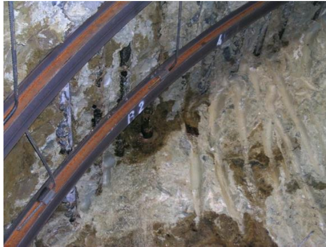
Εικόνα 2.31: Σήραγγα Ασπρονέρι. Αποστάτες διαμήκους σύνδεσης (Α. Σοφιανός, «Υποστήριξη Υπογείων Έργων», 2015)
