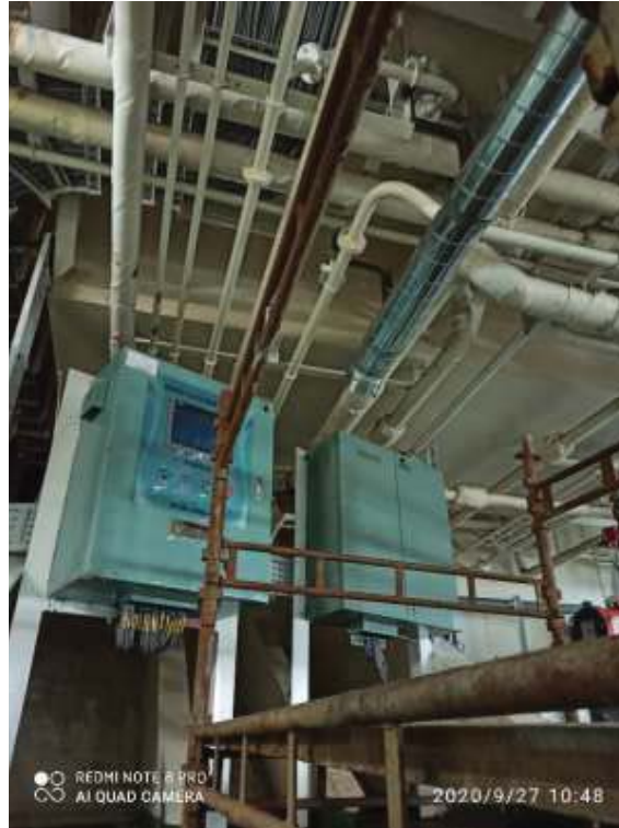
Εικόνα 7.6: Η νέα θέση των Πινάκων Ελέγχου και Παροχής τροφοδοσίας της Μονάδας Υπεριώδους Ακτινοβολίας (UV Power Supply) του συστήματος BWTS P250
