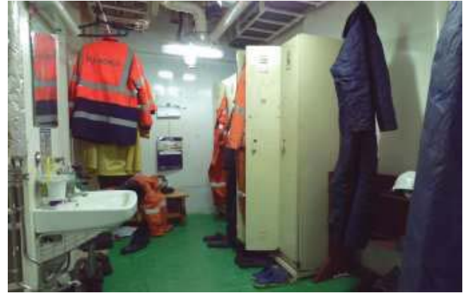
Εικόνα 6.20: Θέση εγκατάστασης των Πινάκων τροφοδοσίας της Μονάδα Υπεριώδους Ακτινοβολίας σε πραγματική εικόνα από το πλοίο
