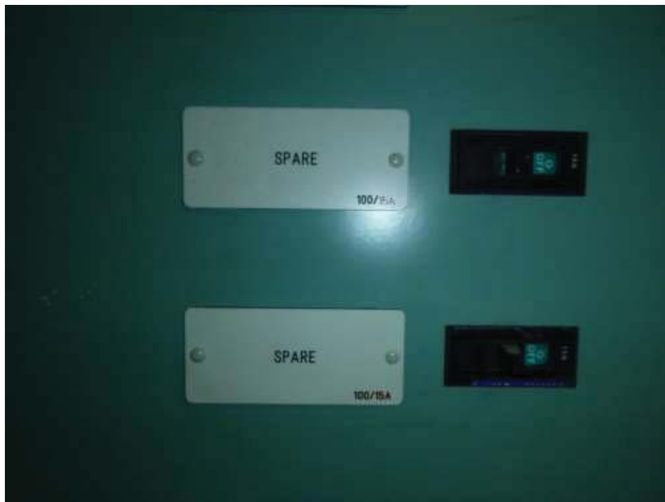
Εικόνα 6.8: Διαθέσιμοι παροχικοί διακόπτες στον Παροχικό Πίνακα του Μηχανοστασίου
