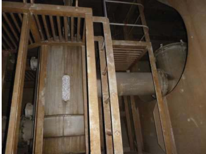
Εικόνα 6.6: Αντλία Έρματος εντός της Δεξαμενής Έρματος 5 Αριστερά
