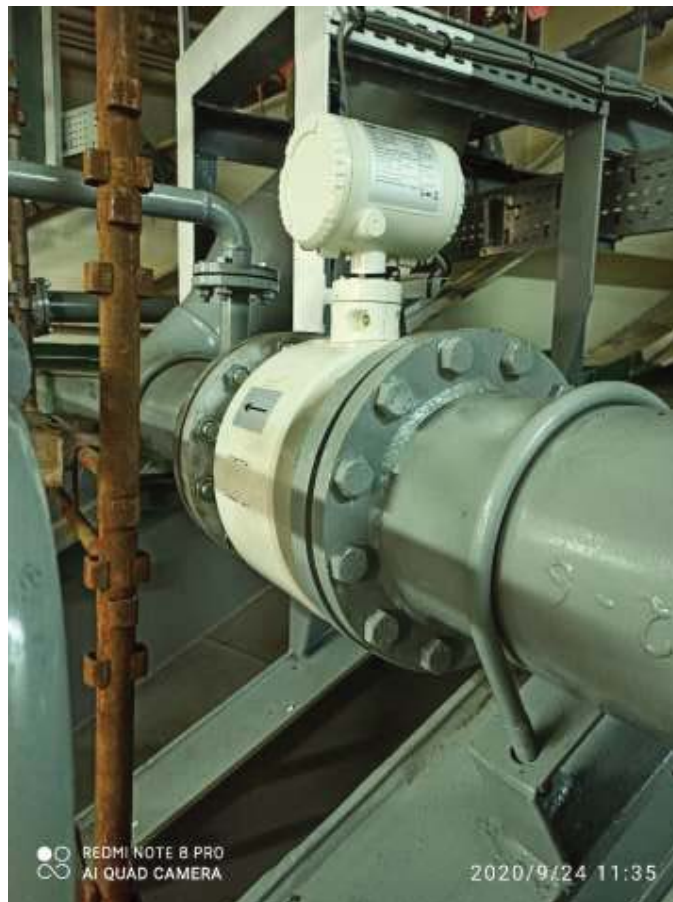
Εικόνα 7.1: Σωλήνωση του συστήματος BWTS P250 του Μηχανοστασίου
