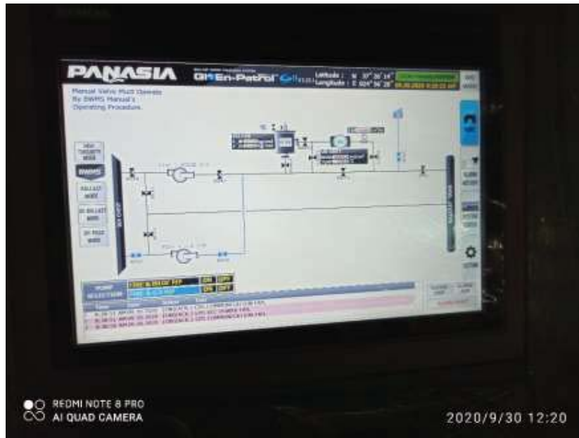
Εικόνα 7.4: Ενεργοποιημένος Πίνακας Ελέγχου του συστήματος BWTS P250 του Μηχανοστασίου κατά την διάρκεια του Αρχικού τεστ
