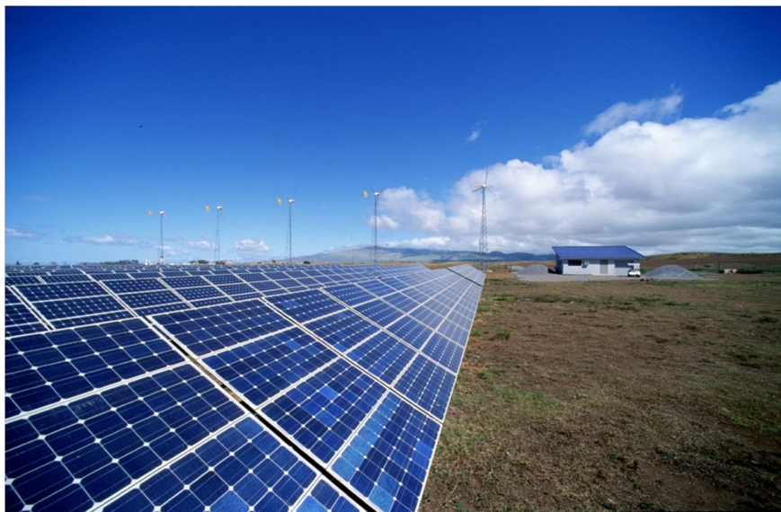
Εικόνα 1.6 : Εγκατεστημένο φωτοβολταϊκό σύστημα
