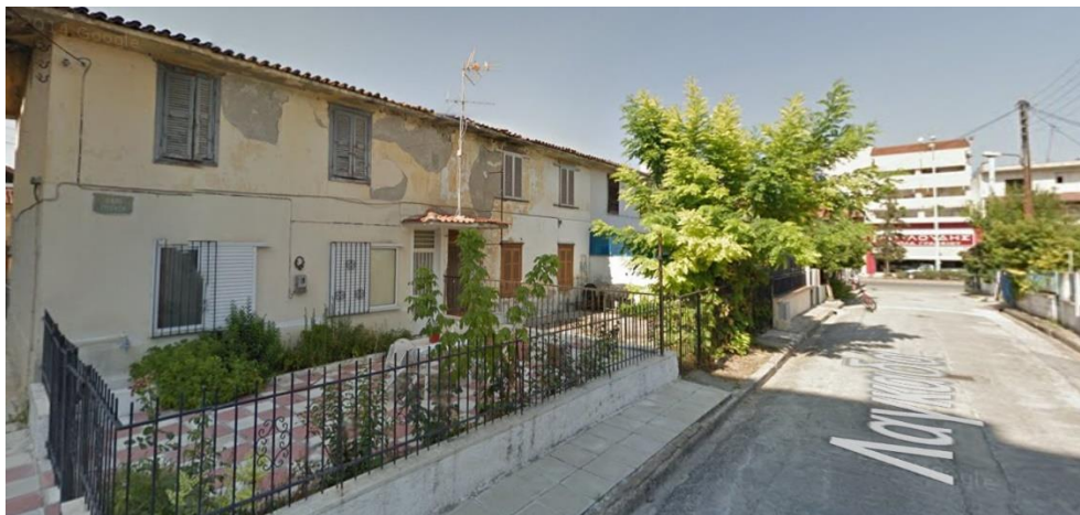
Εικόνα 3.14 Στο υπό εξέταση τμήμα υπάρχουν εμφανής φθορές στα κτίρια S6=0 (Πηγή: Street View)
