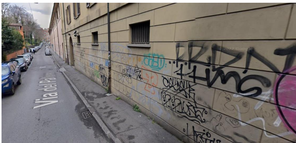
Εικόνα 3.16 Στο υπό εξέταση τμήμα υπάρχουν γκράφιτι στα κτίρια S7=0 (Πηγή: Street View)
