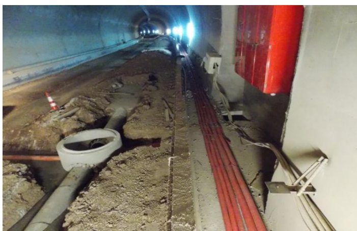
Εικόνα 3-7 Σύστημα συλλογής υδάτων σήραγγα Πλατάνου (ανατολικό στόμιο) (Πηγή: 9 η ετήσια έκθεση ΟΛΥΜΠΙΑ ΟΔΟΣ ΑΕ)
