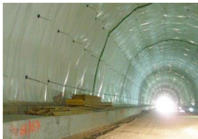
Εικόνα 3-6 Εργασίες υδατοπροστασίας και τελική κάλυψης στη σήραγγα Μαύρα Λιθάρια (Πηγή: 7 η ετήσια έκθεση ΟΛΥΝΠΙΑ ΟΔΟΣ ΑΕ)
